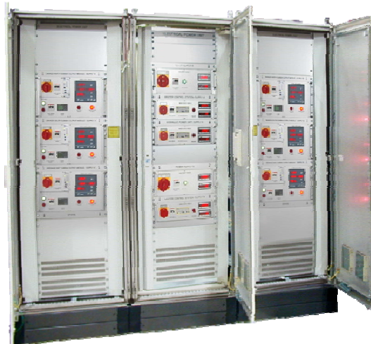
FIG. II.26 Unidad de Potencia Eléctrica Propiedad CAMERON
