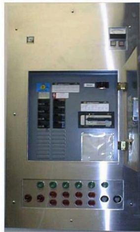
Figura 5.8.2 Tablero de aislamiento.
