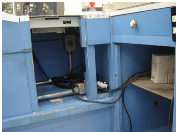
2.10 Instalaciones eléctricas inadecuadas
