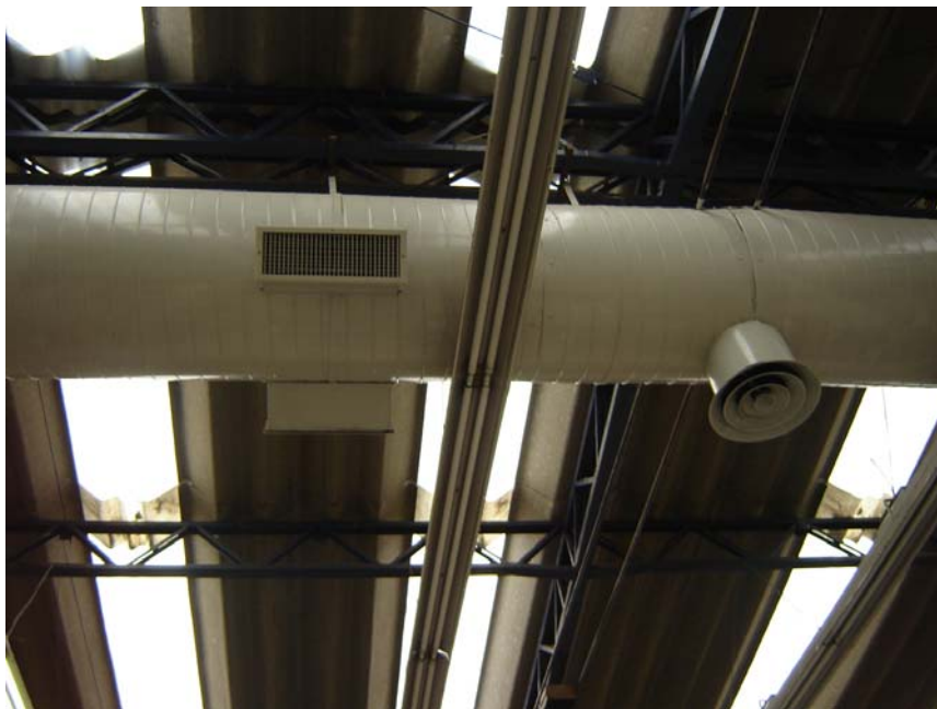
Figura 2.5 Sistema de Aire Acondicionado
