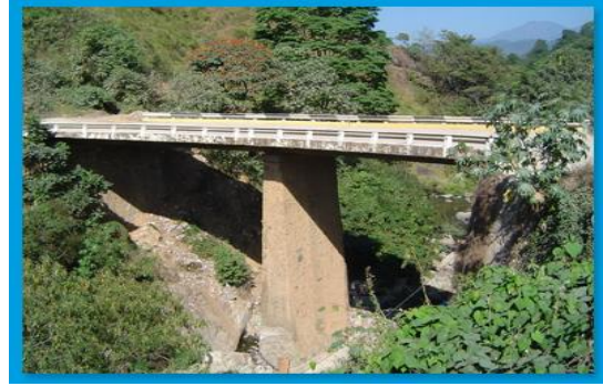
Figura 5. Puente en mal estado.
