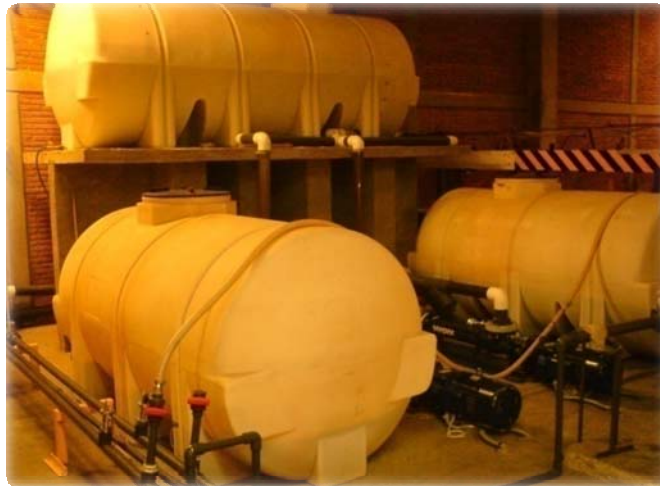
Fig. 6.17 Separador (parte superior) y tanques de almacenamiento de agua y aceite.
