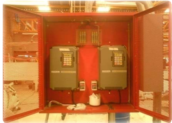
Fig. 6.13 Variadores de frecuencia
