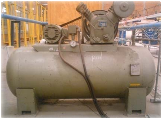
Fig. 6.14 Equipo de compresión de aire
