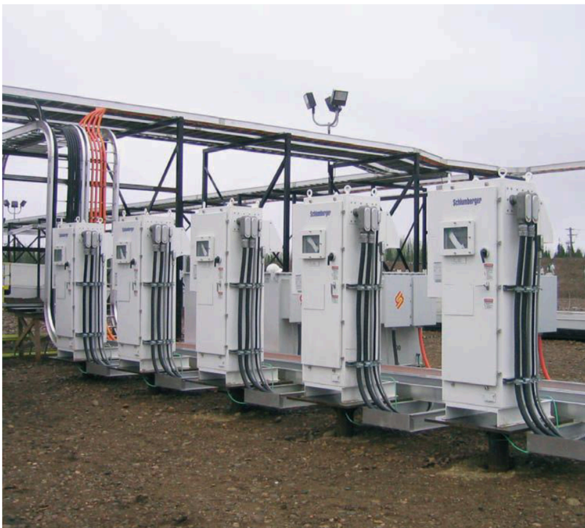
Fig. 1.6 Variadores de velocidad (VSD). Utilizando la electricidad generada por la empresa de electricidad local o en estaciones generadoras dedicadas, el VSD transmite la energía eléctrica dentro del pozo hasta el sistema ESP. El VSD es clave para controlar el desempeño de la bomba en forma remota. 17
