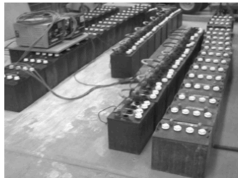
Figura I. 7: Baterías de Ácido-Plomo
