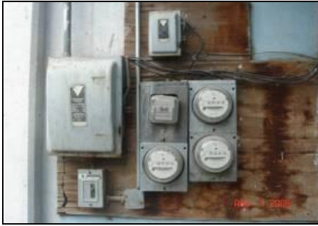
Figura 2.1 Medidores e interruptores. Fuente: Toma propia del taller
