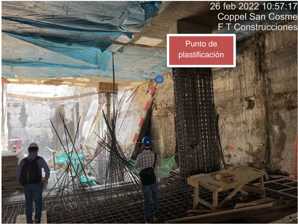
Figura 18. Paneles fallados, apuntalados por una losa
