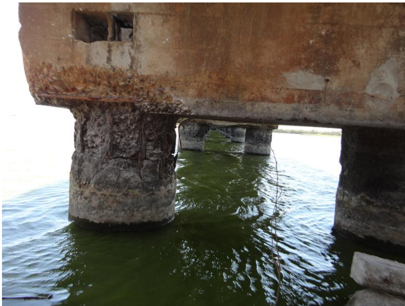
Figura 15 Daños por sulfatos
