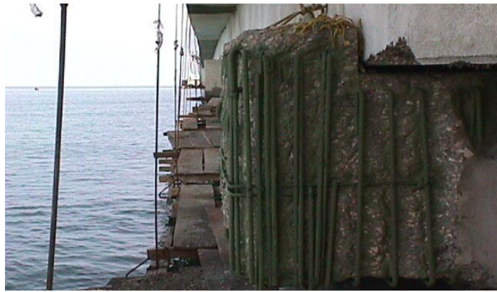
Figura 14 Daños por sales
