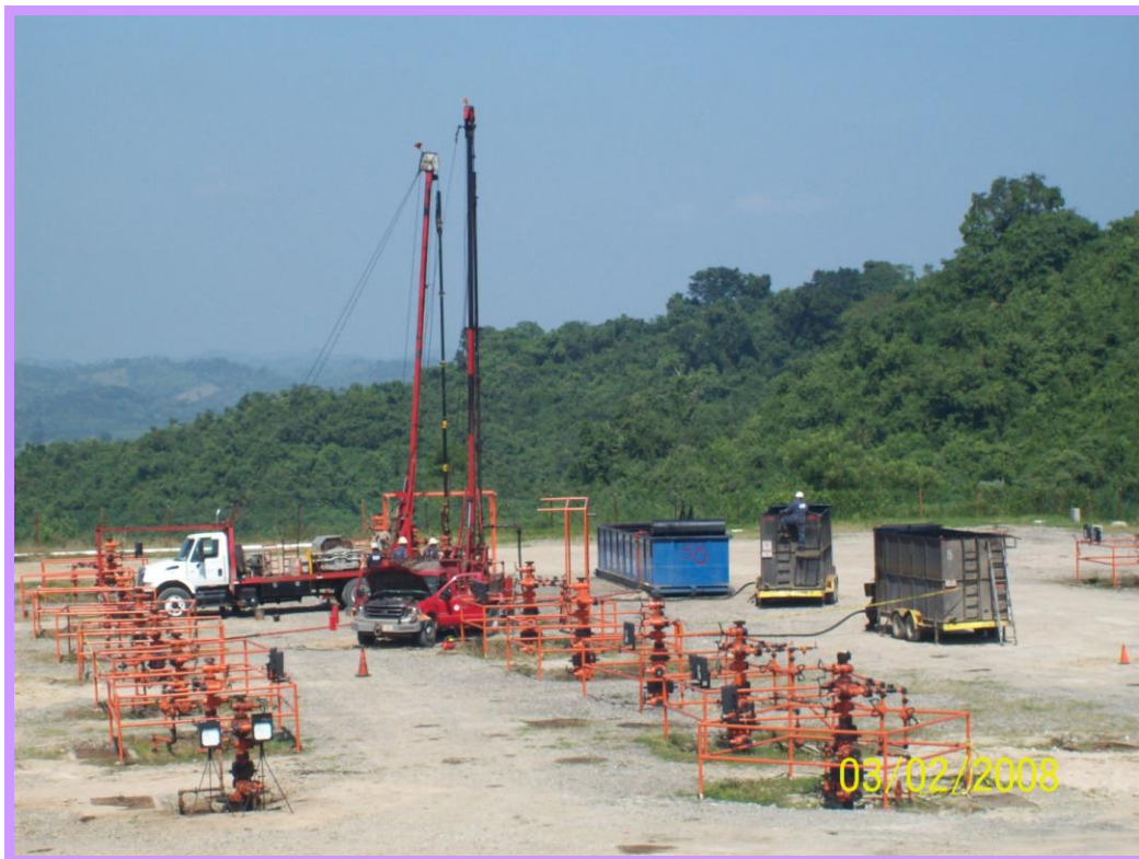
Unidades Swab Instaladas
