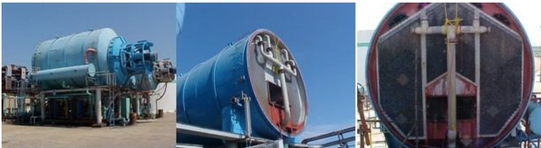
Figura 2.1 Evaporadora MVC. [CFE 2008]
