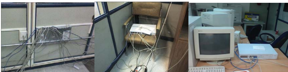
Fig. 2-15 Switch usados como extensión
