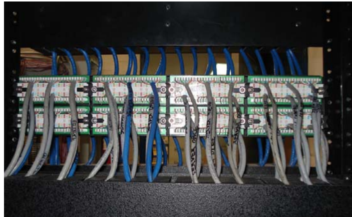
Fig. 3-7 Acercamiento al panel de parcheo
