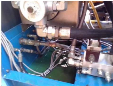
Ilustración 26. Evidencia No.1 falla en consola UPH del freno de emergencia.
