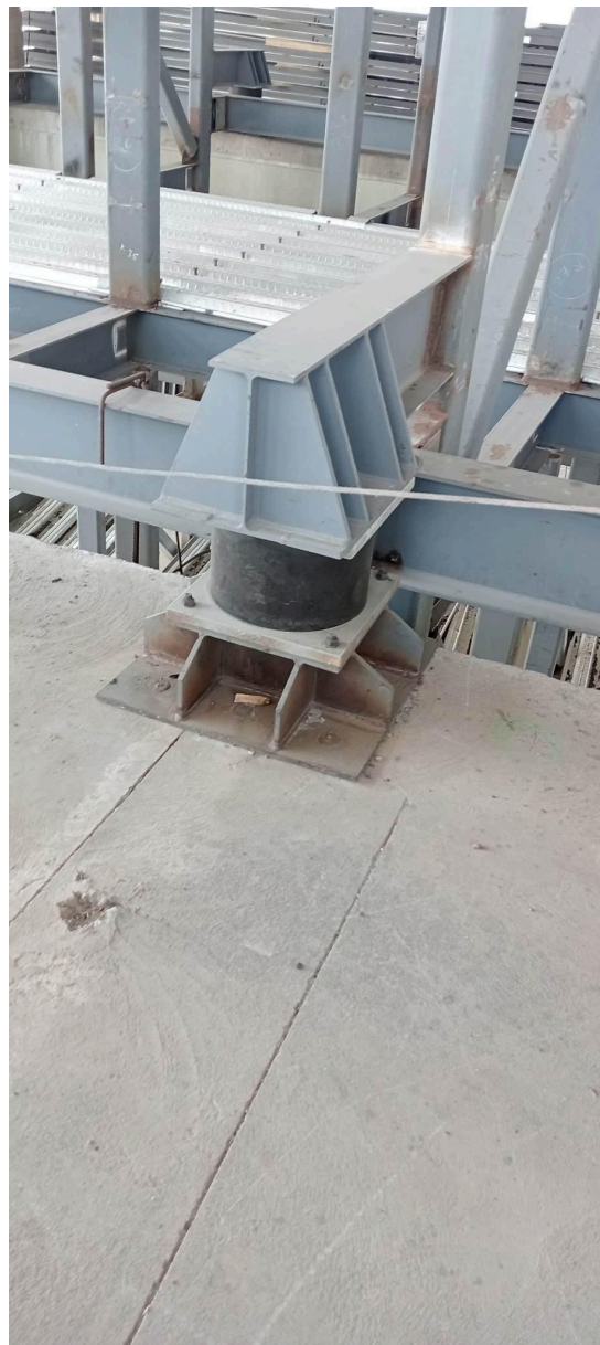
Figura 64. Aislador sísmico de un conjunto de elevadores.
