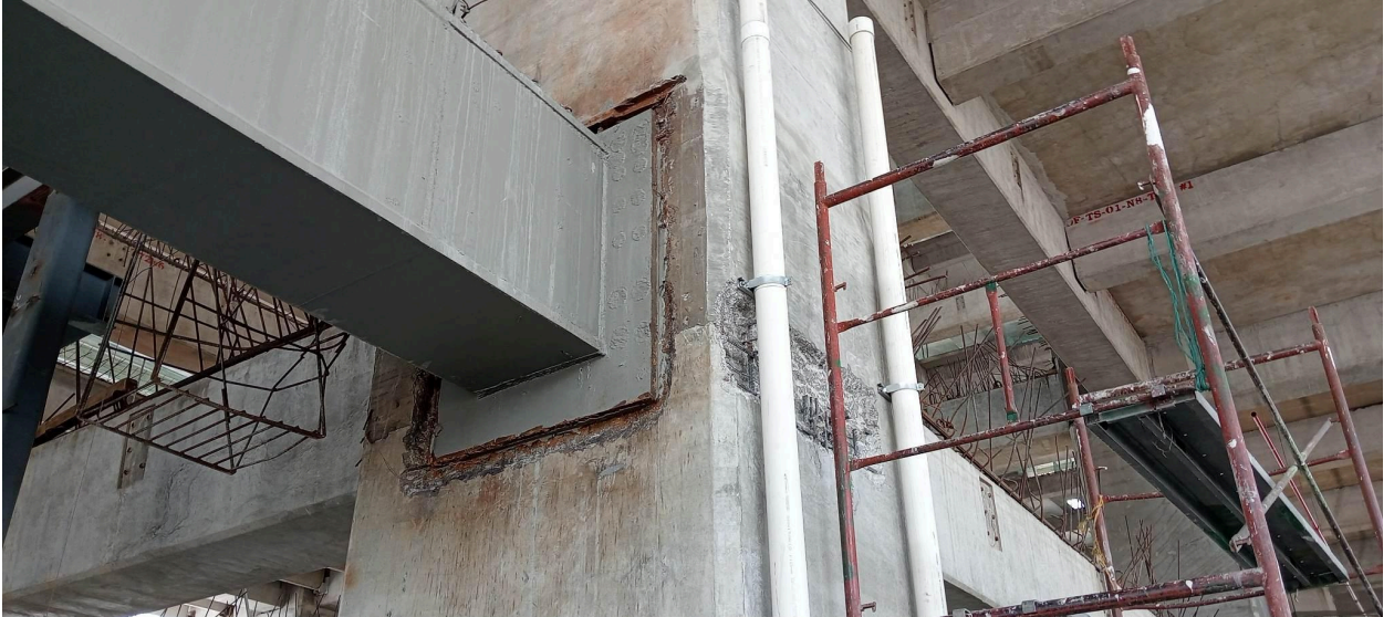
Figura 66. Union de columna-viga con corte irregular.
