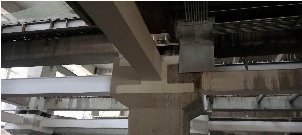
Figura 74. Unión viga-columna en nodo de entre piso entre sótano 1 y planta baja.
