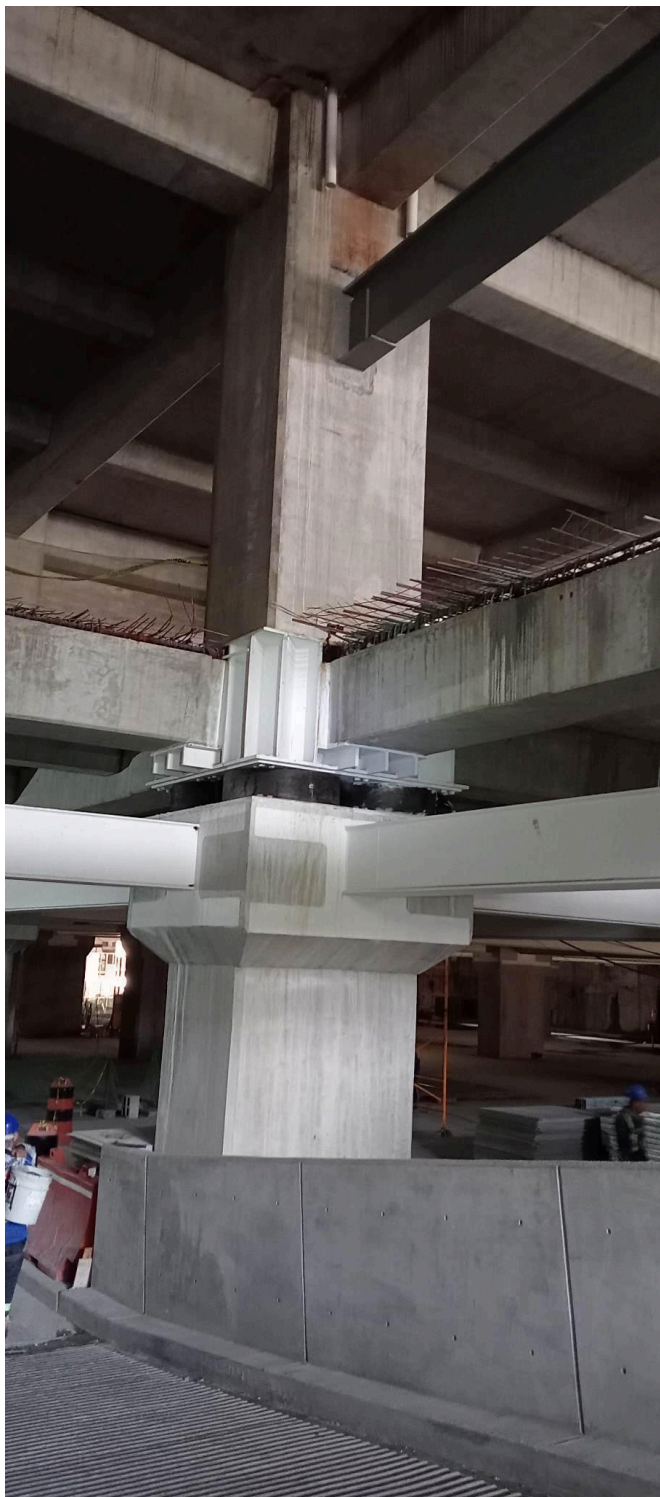
Figura 65. Aislador sísmico en planta baja, entre capitel y columna mixta.
