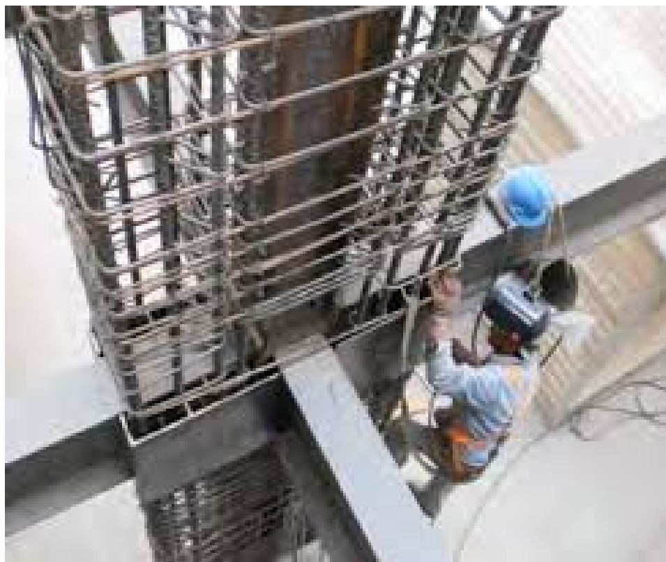
Figura 48. Columna mixta de perfil embebido y armado de acero de refuerzo en construcción.
