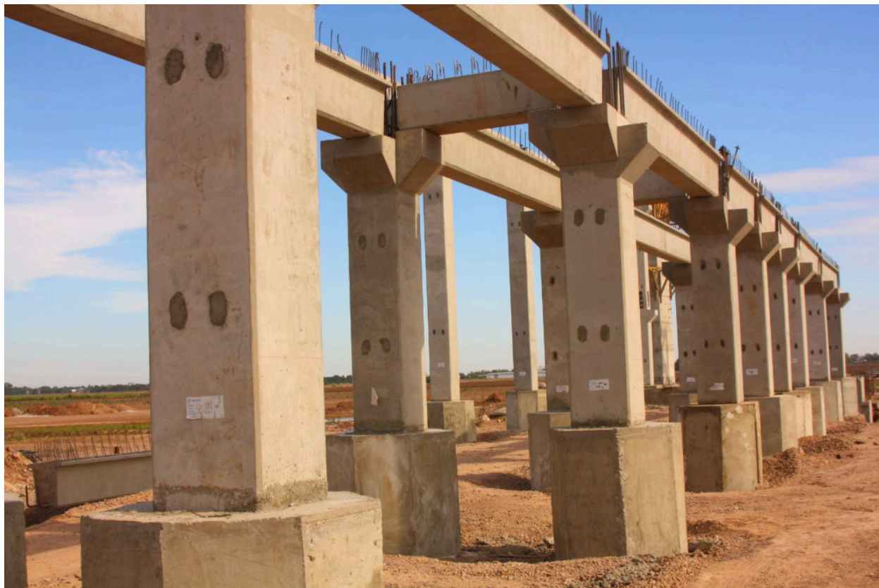
Figura 45. Columnas pre-fabricadas de la empresa Trabis.
