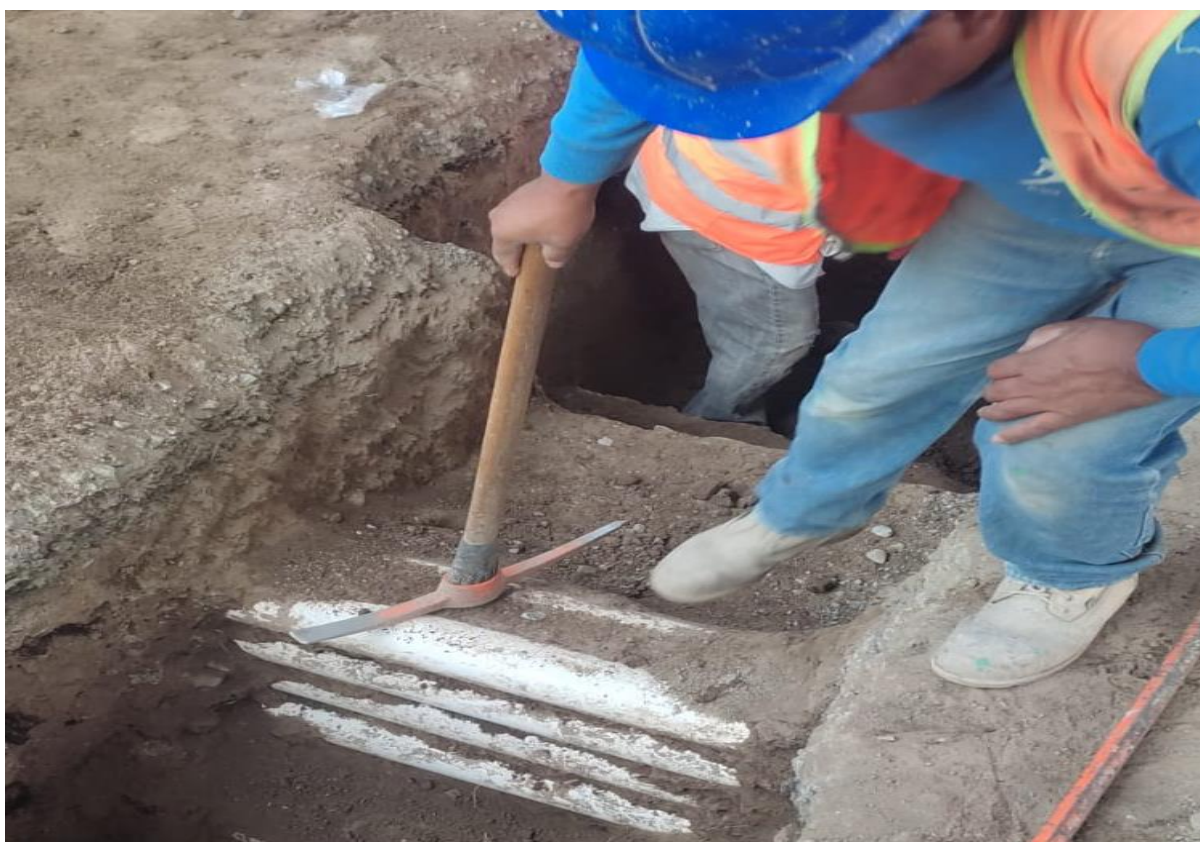
Imagen 24: Cala realizada bajo centenario con interferencia de líneas de TELMEX y CFE km 1+200.
