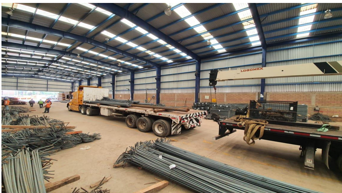
Imagen 39: Planta de habilitado del proyecto Río de los Remedios tramo 4.1, La presa.
