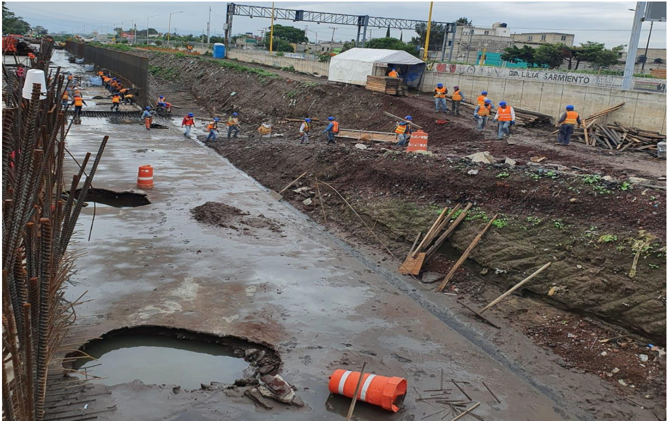
Imagen 38: Carcamos de bombeo para achique por inundación.
