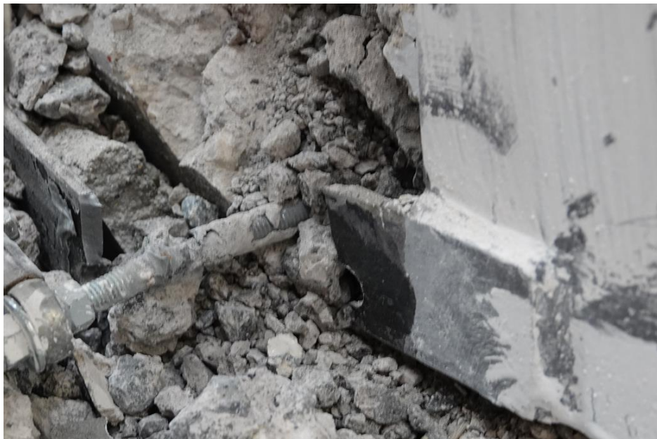
Fig. 3.3.208 Solera fracturada - Columna C-4 (Instituto de Ingeniería, 2021 - 2023)
