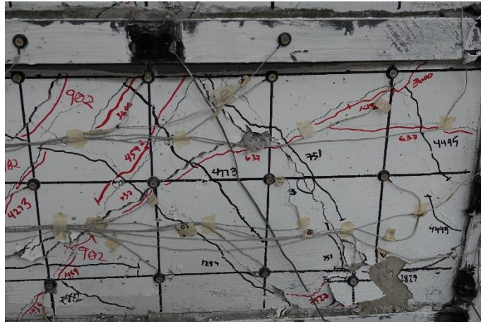
Fig. 3.3.131 Daño en cara norte - Columna C-2 (Instituto de Ingeniería, 2021 - 2023)
