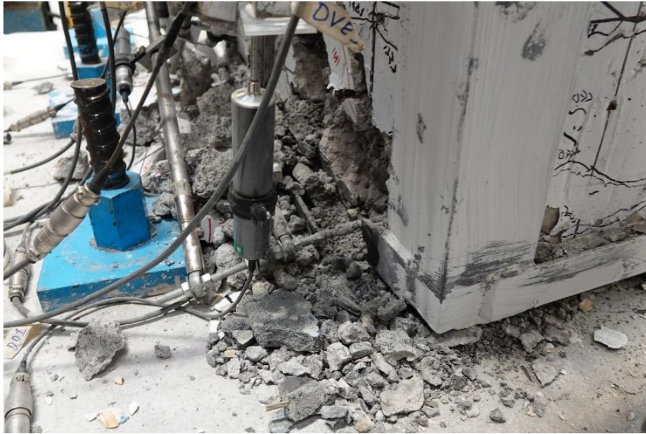
Fig. 3.3.207 Solera inferior fracturada - Columna C-4 (Instituto de Ingeniería, 2021 - 2023)
