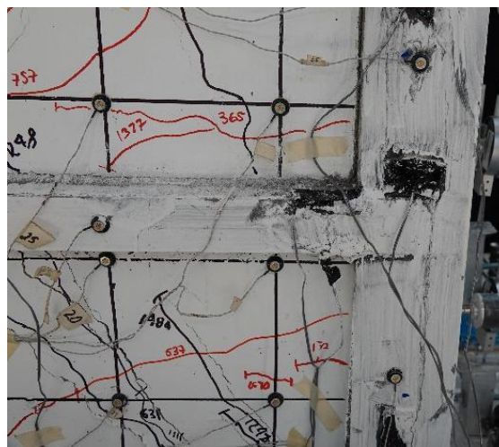
Fig. 3.3.192 . Desprendimiento de la pintura a base de cal ( R=-2.5\% ) - Columna C-4 (Instituto de Ingeniería, 2021 - 2023)
