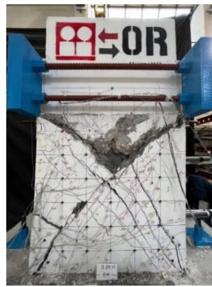
Fig. 3.3.50 Daño en el espécimen ( R=1.5\%(2) ) - Columna OR (Instituto de Ingeniería, 2021 - 2023)
