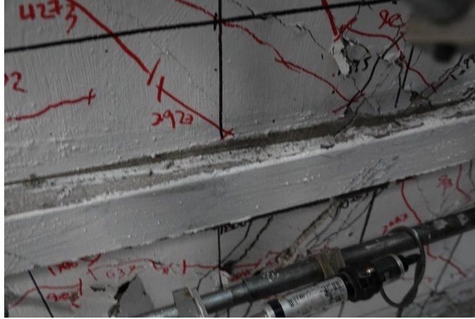
Fig. 3.3.129 Deslizamiento de grout - Columna C-2 (Instituto de Ingeniería, 2021 - 2023)
