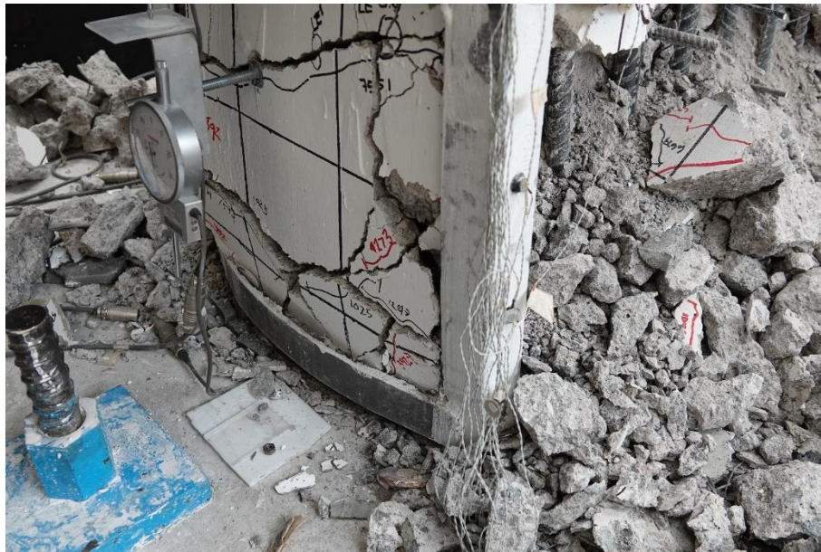
Fig. 3.3.172 Estado final del daño, deformación de solera - Columna C-2 (Instituto de Ingeniería, 2021 - 2023)
