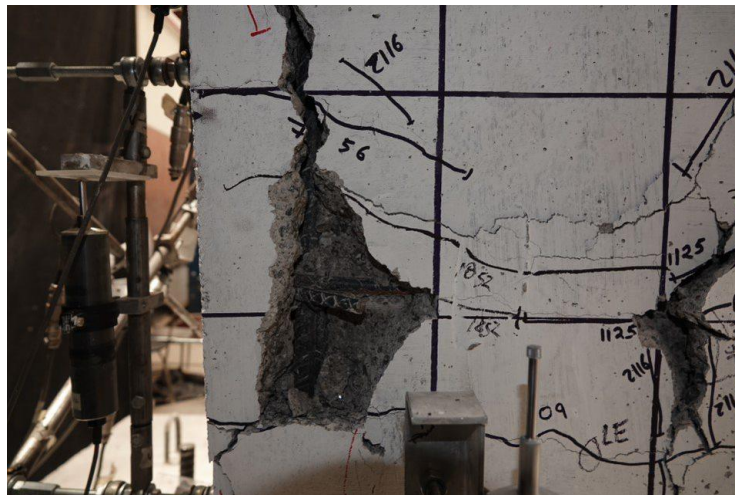
Fig. 3.3.90 Acero de refuerzo expuesto cara este - Columna O*
