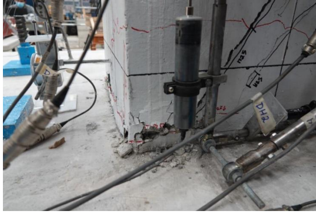
Fig. 3.3.81 Daño en la base de la columna - Columna O* (Instituto de Ingeniería, 2021 - 2023)
