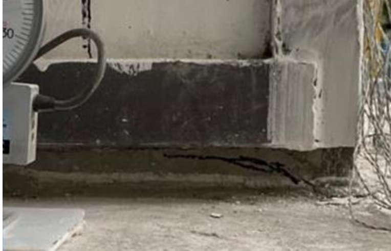
Fig. 3.3.113 Agrietamiento en la base de la columna - Columna C-2 (Instituto de Ingeniería, 2021 - 2023)
