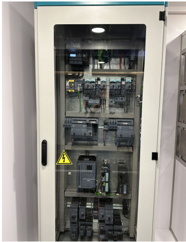
Figura 2.4 Gabinete resguardando componentes de un sistema de automatización
