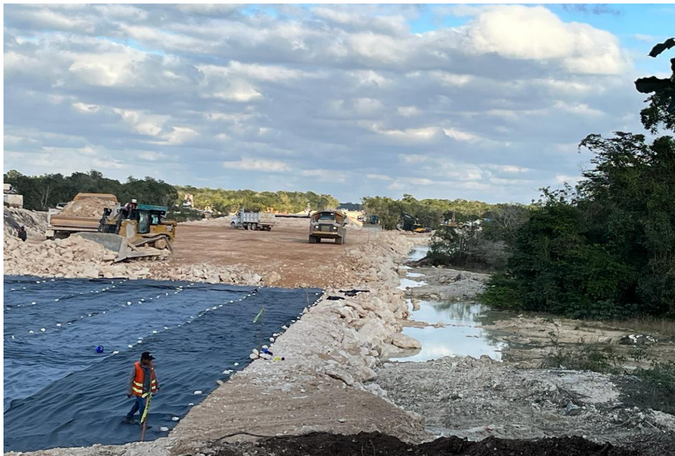
Figura 3.2 Vibración por Maquinaria. Tren Maya Tramo 4, México.
