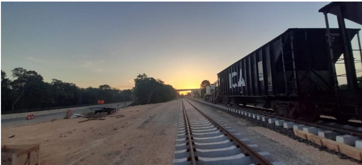
Figura 3.4 Vibración por transporte público. Tren Maya Tramo 4, México
