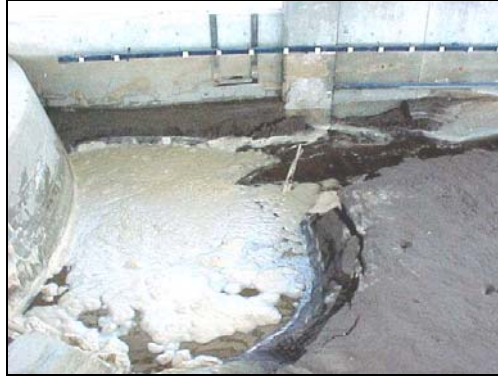
Cono de socavación, 60 min. en modelo.
