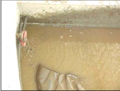
Desagüe de fondo obstruido, 75 min. en modelo.
