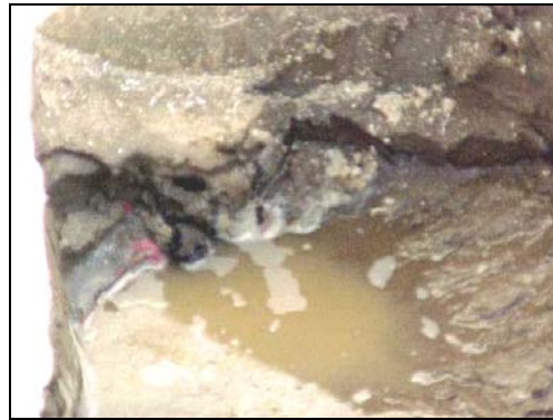
Obstrucción del desagüe, 120 min. en modelo.
