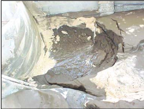
Cono de socavación, 120 min. en modelo
