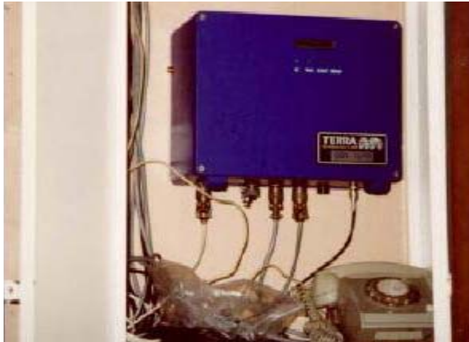
Figura 4.6. Equipo de medición maestro tipo GSR-12 que se encuentra instalado en la azotea del edificio
