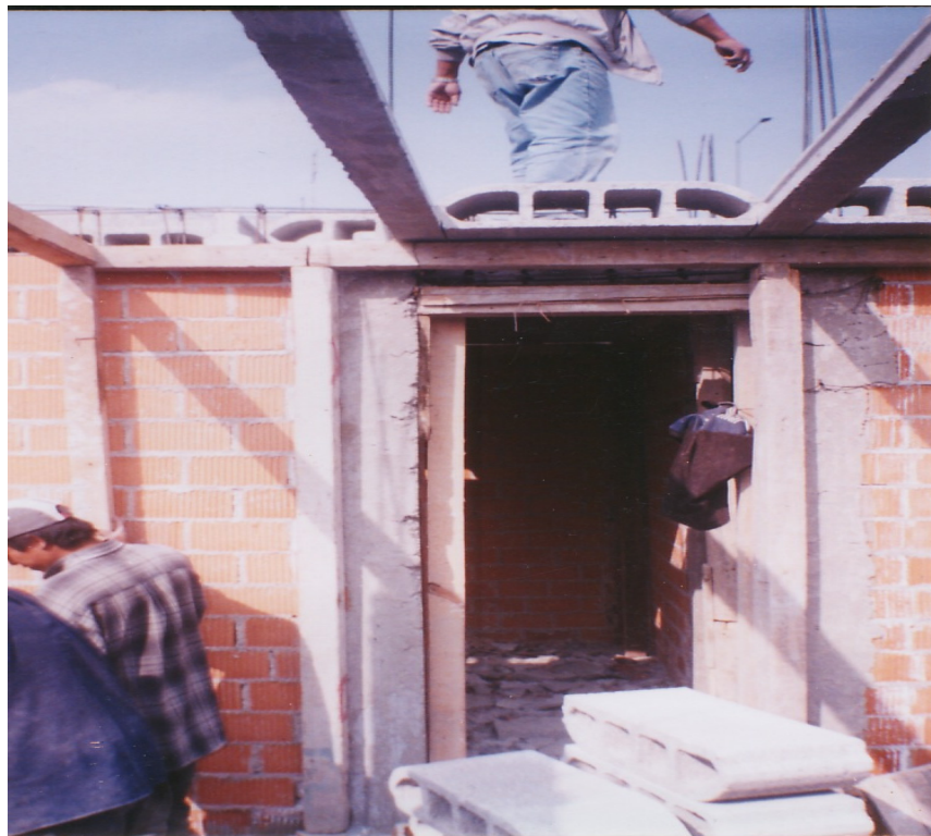
FIG IX.2 COLOCACION DE BOVEDILLAS , LAS DIMENSIONES DE LAS BOVEDILLAS ESTAN DETERMINADAS POR LOS EJES DE LAS VIGUETAS.
