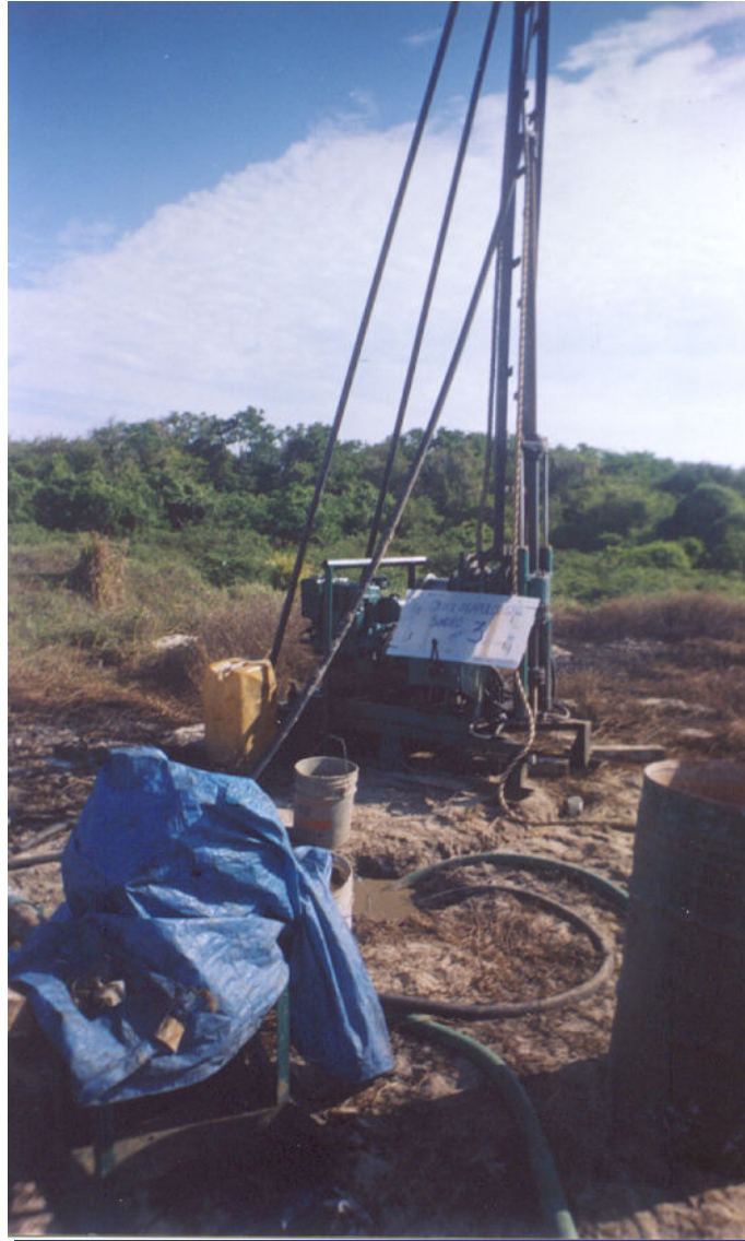
FOTO19. En la zona donde se efectuó el Sondeo SPT-3, la capa vegetal ya se presenta con un espesor aproximado de 10cm.
