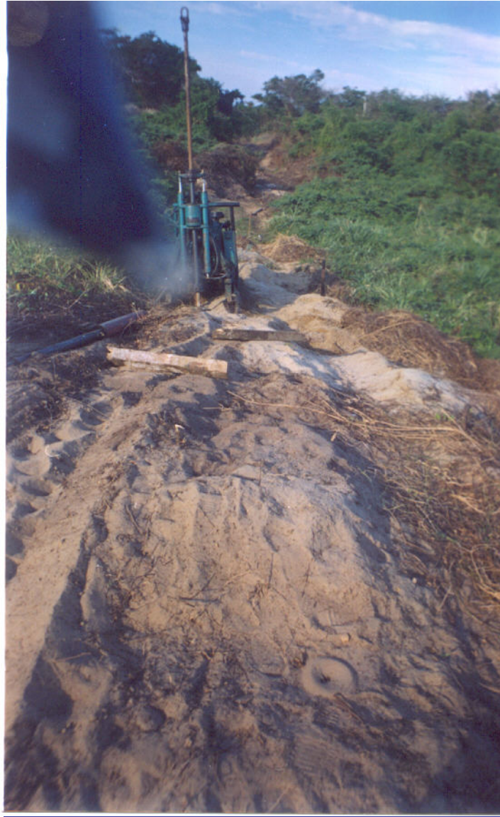
FOTO15. Se ilustra el Sondeo Mixto SM-1, el cual llegó hasta una profundidad de 10.50m. En esta zona se observa la presencia de arena suelta de relleno y un escaso espesor de capa vegetal.
