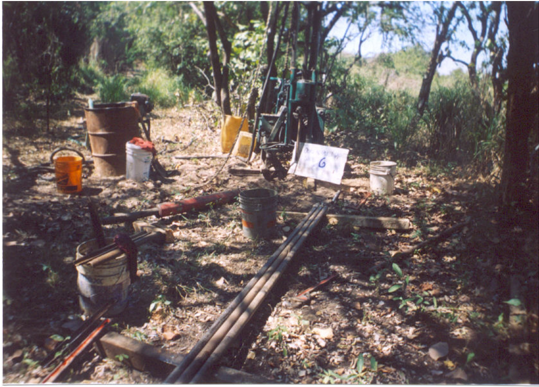
FOTO25. Finalmente se visualiza el lugar donde se realizó el Sonde SPT-6, en donde fue muy difícil el acceso debido a la abundante vegetación que ahí se encuentra.
