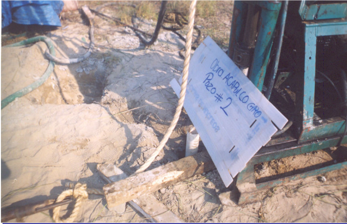
FOTO18. En esta ocasión se presenta ya la perforación realizada en el Sondeo Mixto SM-2, tenemos el pie de la máquina perforadora, así como la tubería utilizada en la misma..
