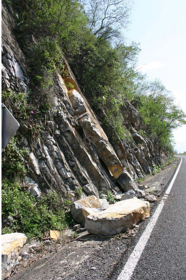
Fotografía 7. Caída de piedra por mala inapropiada exposición de dirección de las juntas.
