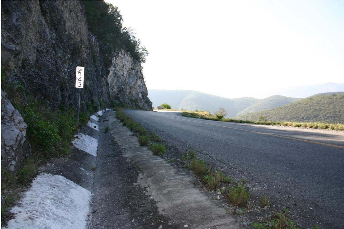
Fotografía 11. Fragmentos de roca sujeta con juntas poco cohesivas y en condiciones apropiadas para el deslizamiento por gravedad.
