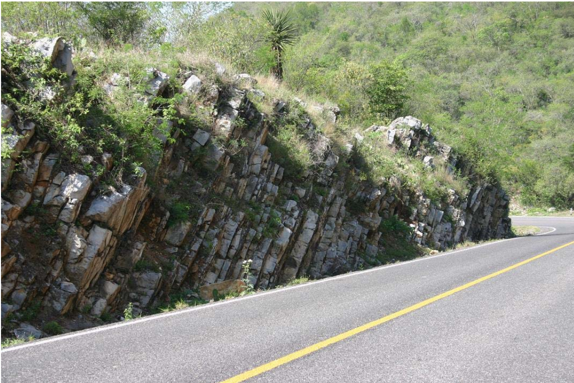
Fotografía 6. Dirección de las juntas propicia para la caída de piedra.
