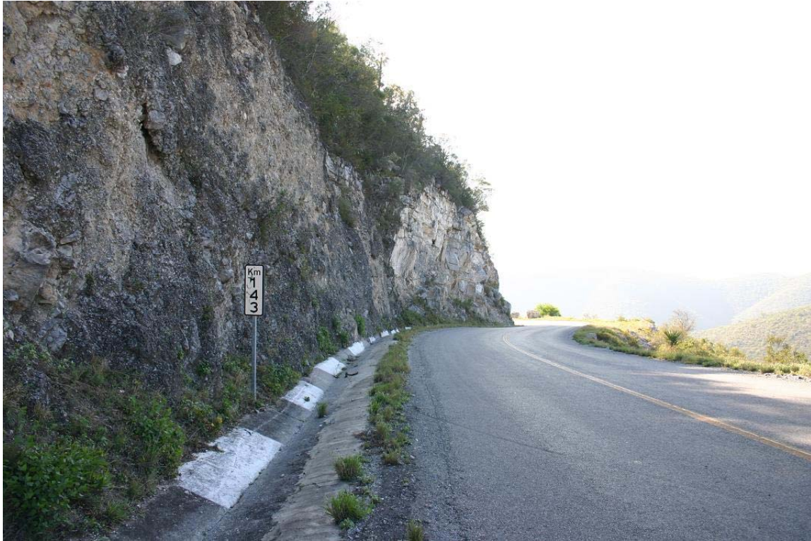
Fotografía 12. Remoción de estratos de suelo por efectos de tubificación y remoción de suelo poco cohesivo.
