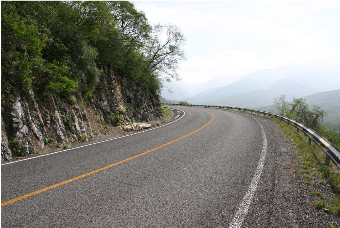
Fotografía 8. Sobreesfuerzos por vegetación sin control.
