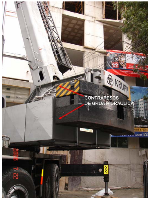
Imagen 4.16 Contrapesos de grúa hidráulica
