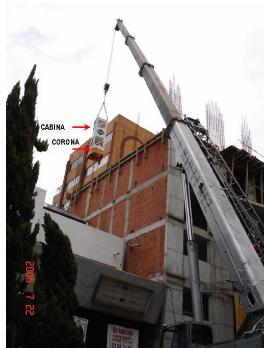
Imagen 4.23 Descenso de cabina y corona
