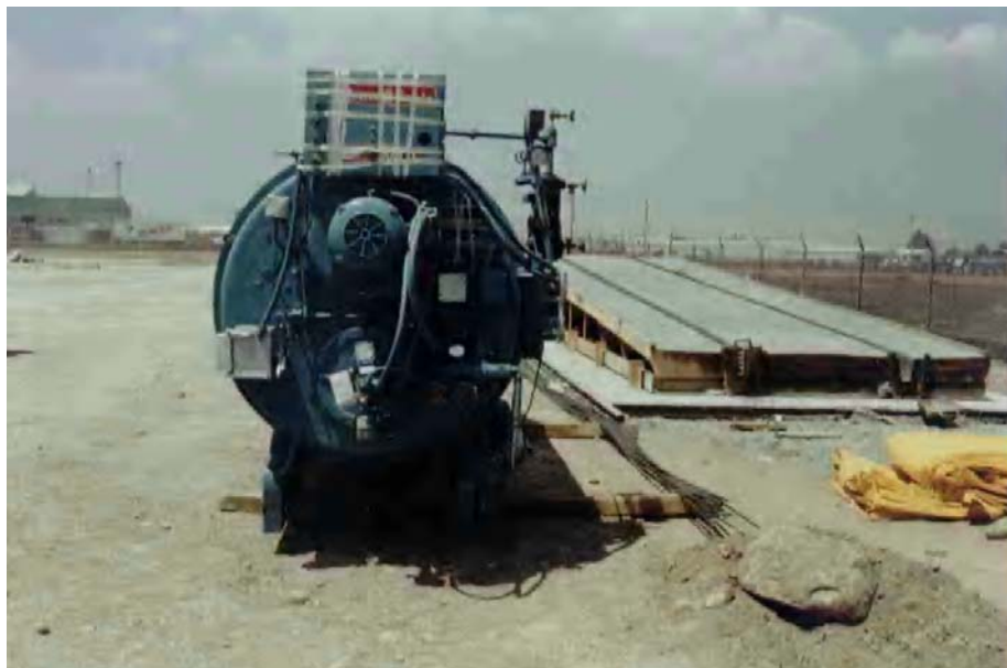
IV.4.2. Caldera generadora de vapor.
