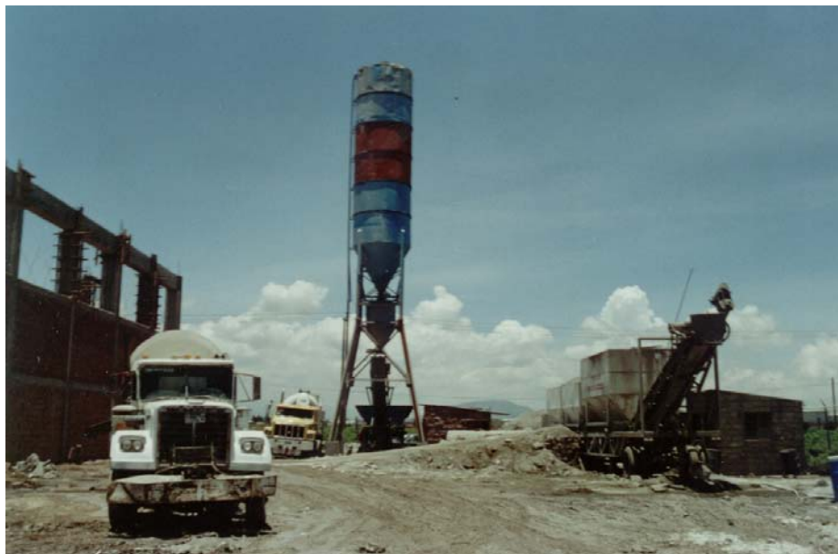
V.1.7. Concretera en funcionamiento. Se observa silo, contenedores de materiales, banda transportadora, pipas con agua y ollas revolvedoras de concreto.
