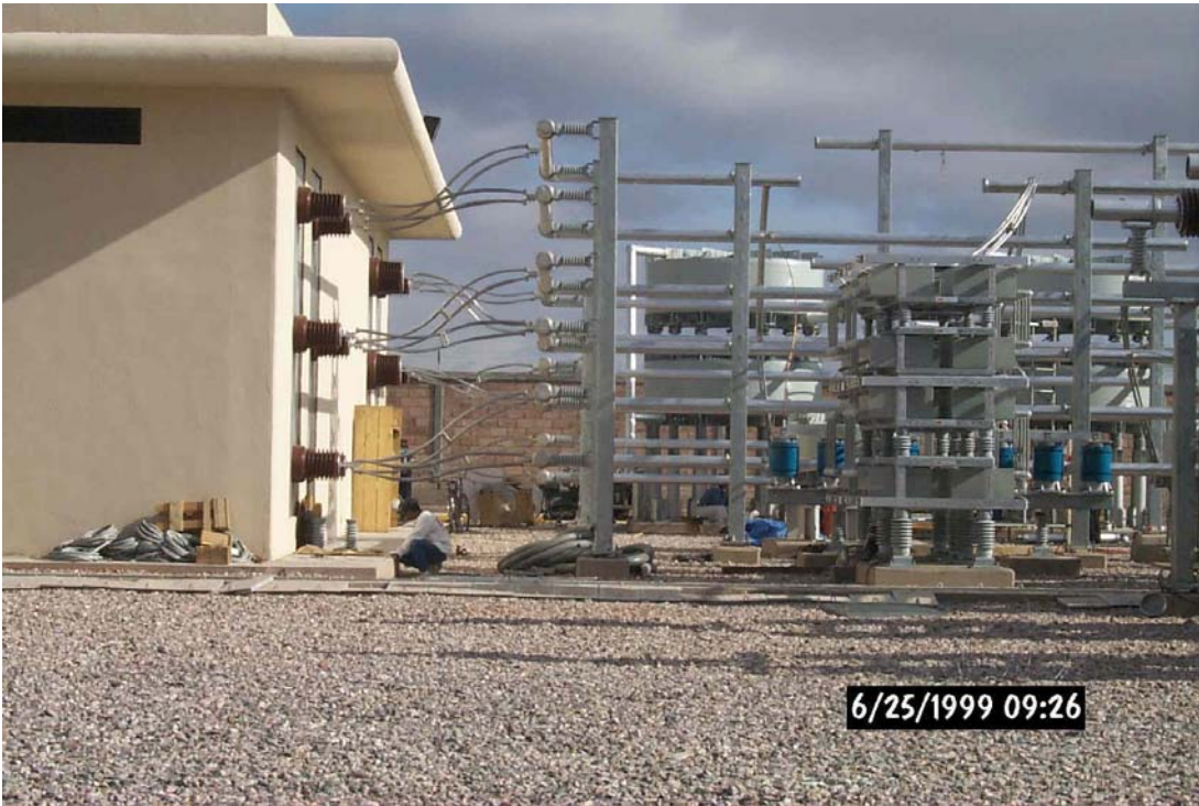
Bancos de Capacitores y Transición hacia el Cuarto de Tiristores
