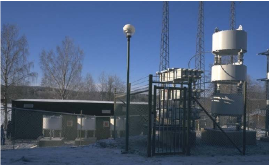
Bancos de Capacitores y Reactores Torres de Comunicaciones
