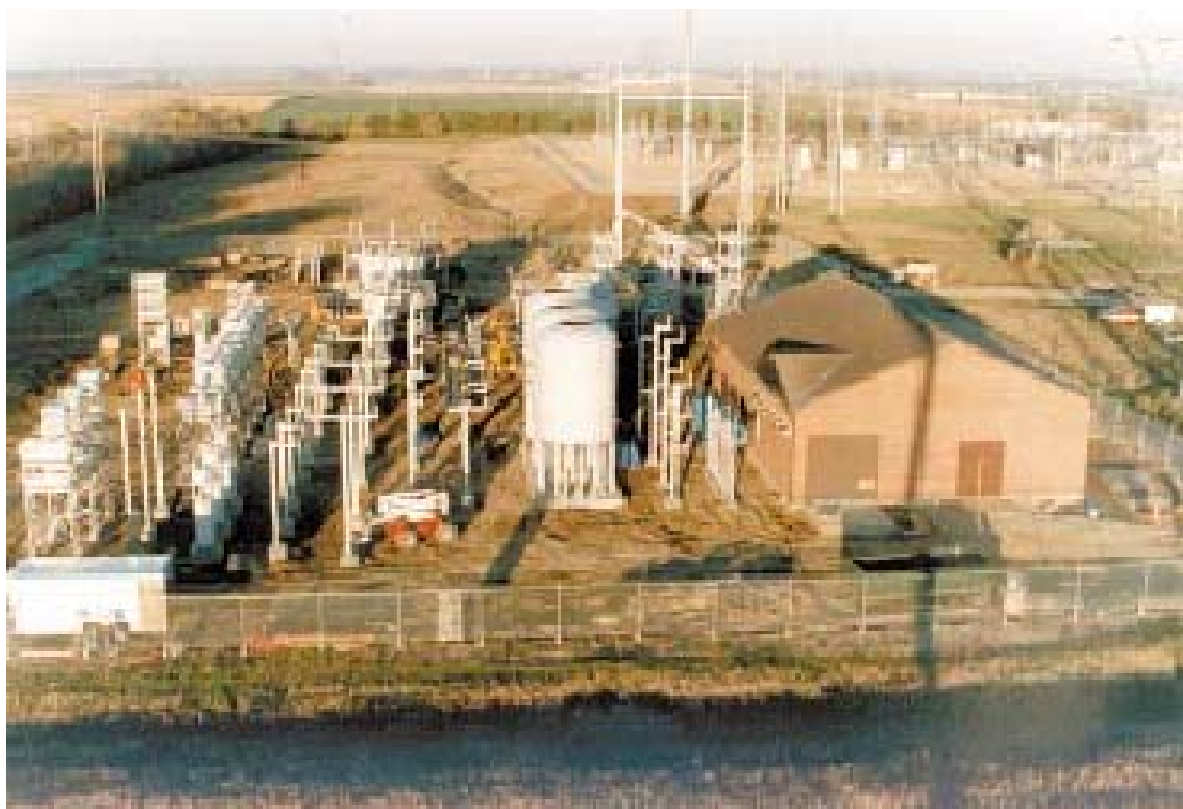
Vista General de un Compensador Estático de VARs de baja Potencia
