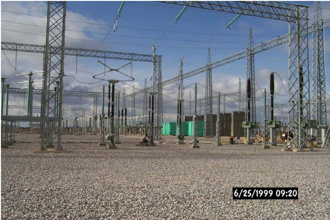
Vista General de la Subestación y Transformadores para el CEV al fondo
