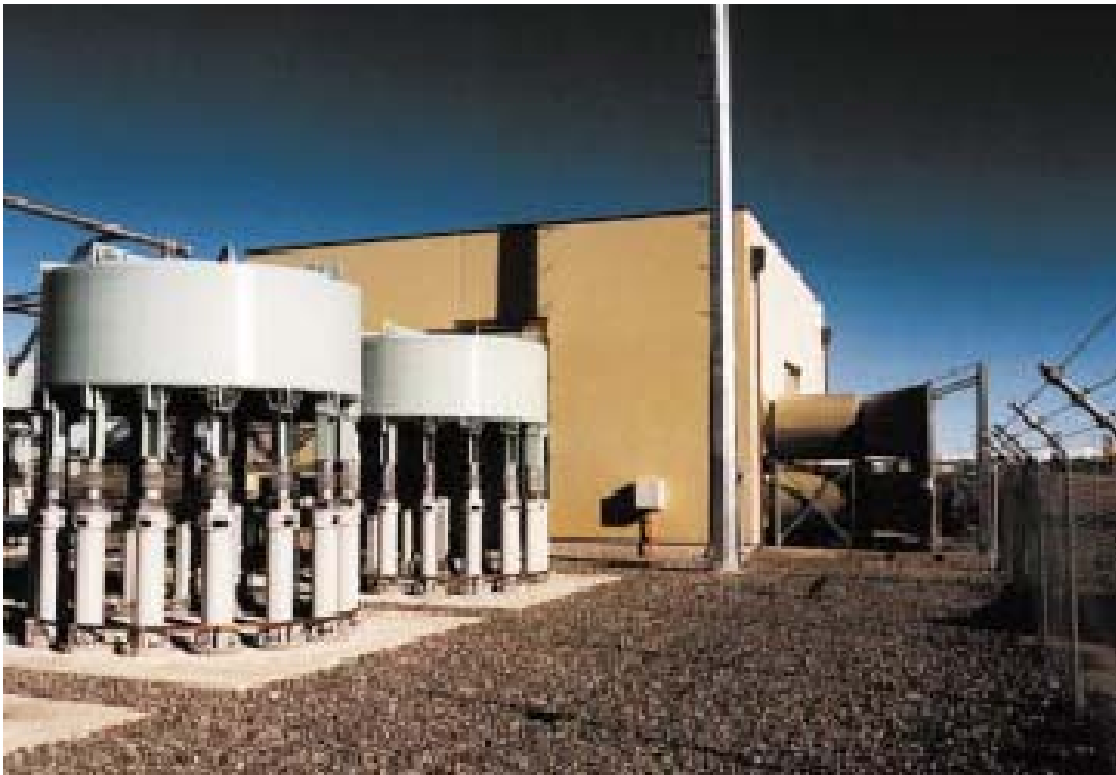
Bancos de Reactores y Caseta de Control
