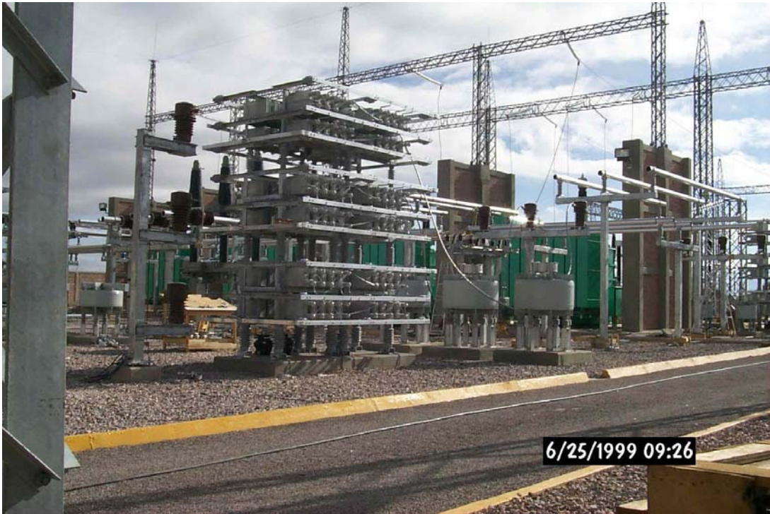
Bancos de Capacitores y Filtros de Armónicas
