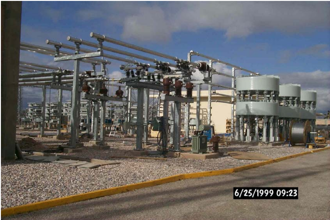
Banco de Reactores y Buses de Media Tensión
