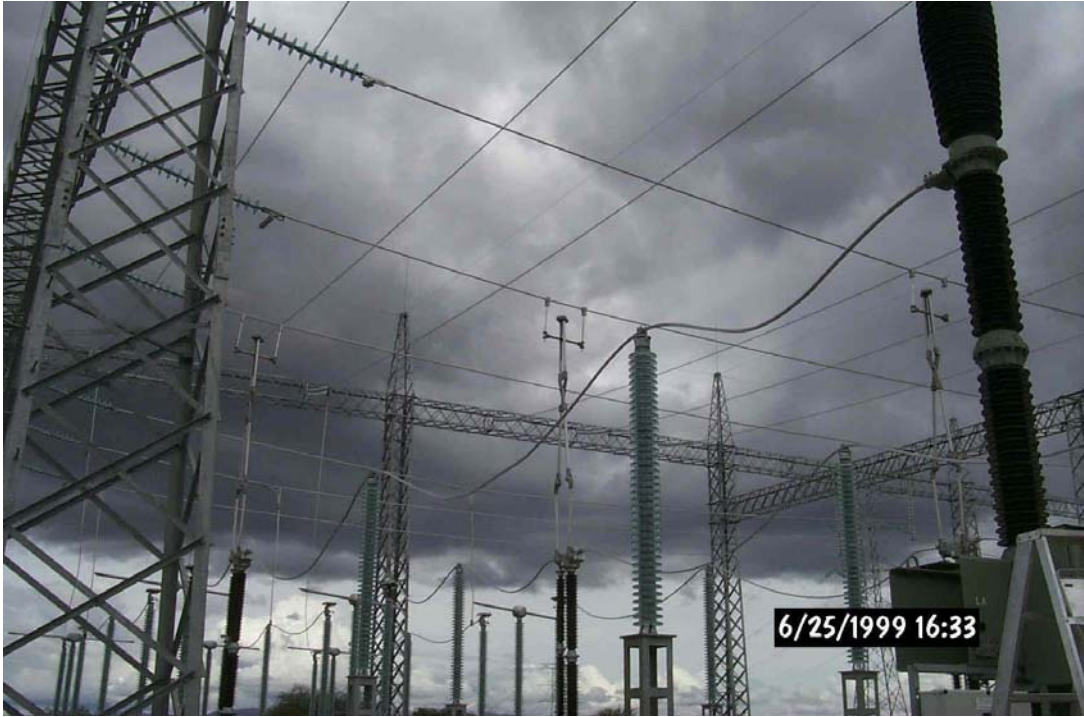
Vista General de una Subestación de Potencia
