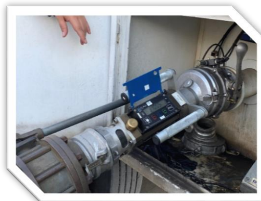
Figura VI.16; Fotografía medidor del transportista durante la descarga.
