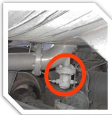
Figura II.30; Fotografía válvula neumática.
