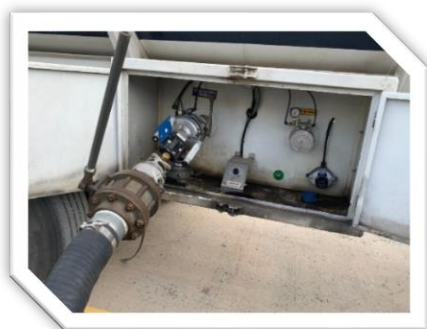
Figura VI.9; Fotografía medidor del transportista.
