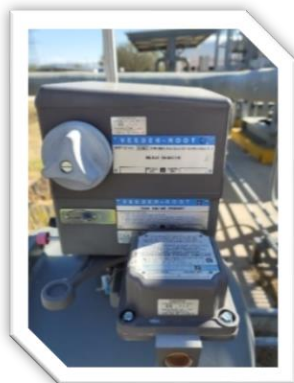
Figura VI.2; Fotografía Cuenta litros Planta A.
