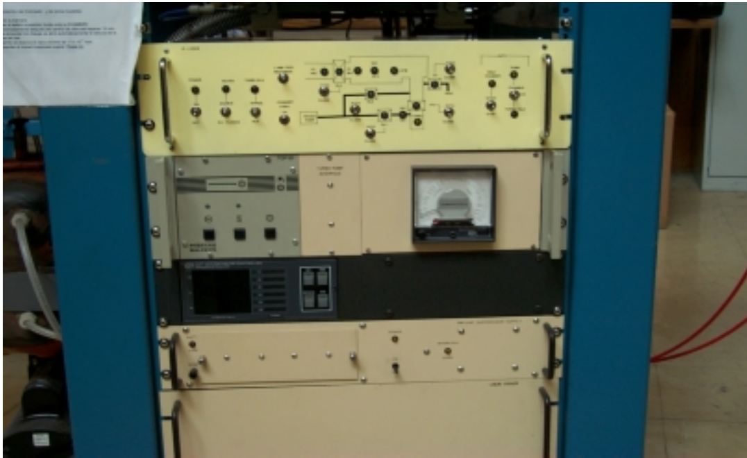
Fig. 4.5 MÓDULO DE AUTOMATIZACIÓN COLOCADO EN EL GABINETE
