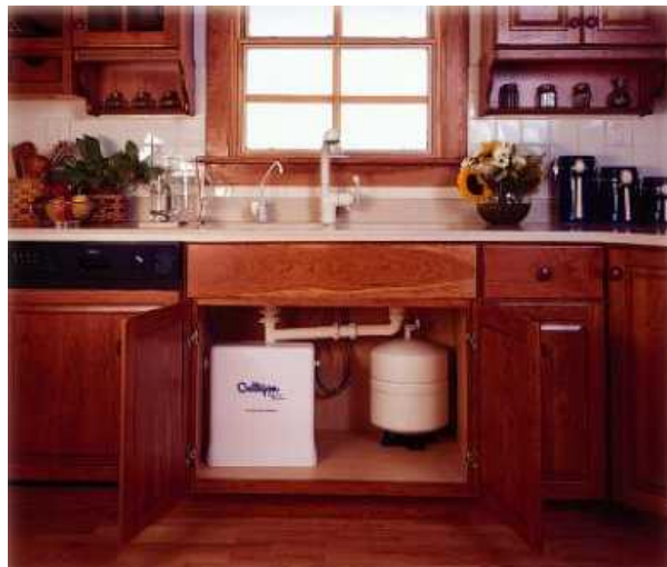
Figura 1.1.4 Equipos de Harmony Brook de México residenciales
