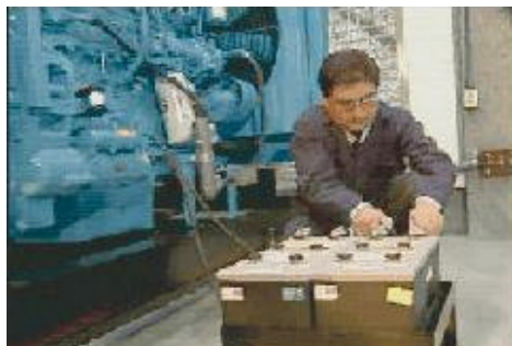
Fig. no. 8 Revisión a baterías.
