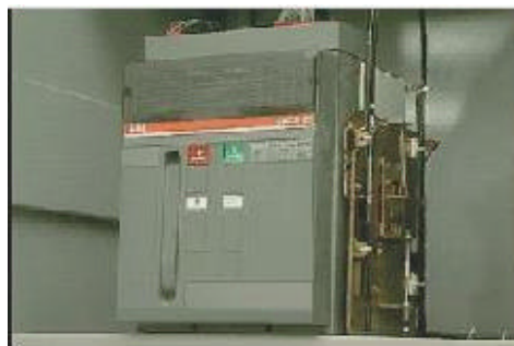
Fig. no. 5 Unidad con interruptor electromagnético
