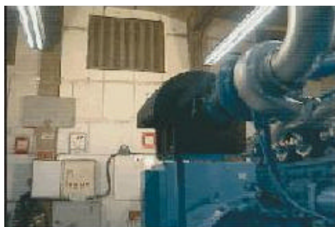
Fig. no. 7 Los conductos de ventilación deben mantenerse limpios para permitir la máxima ventilación dentro del generador
