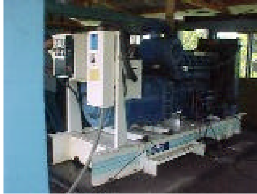
Fig.3 Planta de emergencia utilizada en un Sistema de captación de agua.
