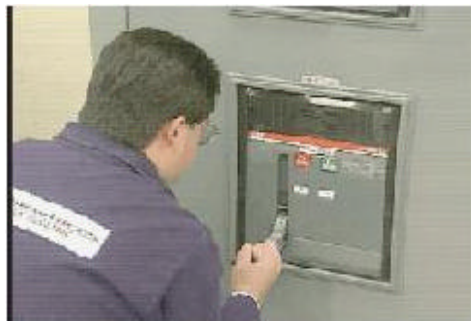
Fig. no.6 Operación del bloqueo manual en una unidad de transferencia.
