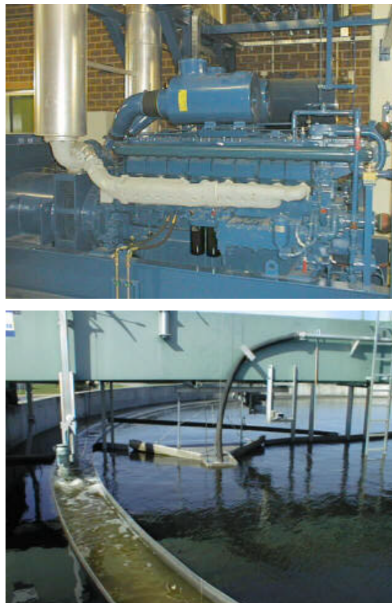
Fig. 4 Planta de emergencia tipo diesel utilizada en el sistema de tratamiento de aguas residuales.
