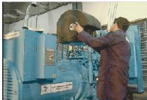
Fig. no. 5 Cambio de filtro de aire.
