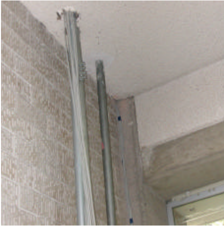
Figura 4.23 Cables UTP sin canaletas
