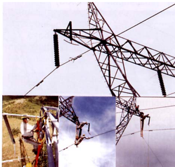
Figura 8.7 Instalación de apartarrayos tipo GAP en líneas de transmisión para disminución de salidas por descargas atmosféricas [4].
