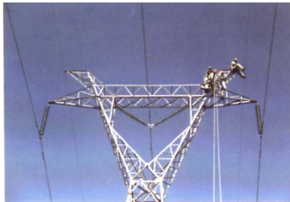
Figura 6.10 Modificación del ángulo de blindaje para minimizar las salidas por descargas atmosféricas en la L.T. 230 kV Zapata-93240-Mezcala. ATT Central.
