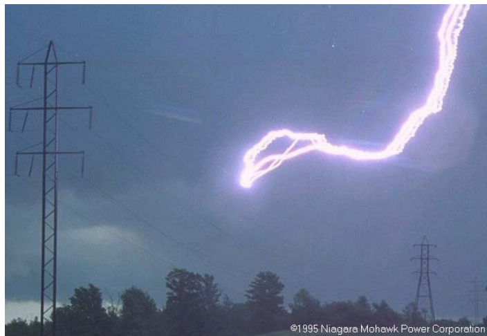
Figura 6.1 Descargas atmosféricas en líneas de transmisión.
