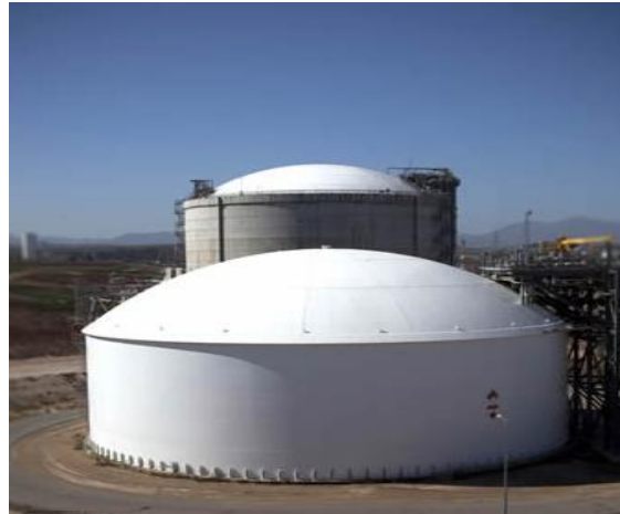
Figura 38. Tanque de almacenamiento de doble pared (Quintero, 2022).
