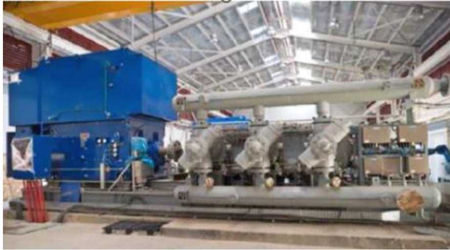
Figura 83. Compresor eléctrico utilizado en Yela (Enagas, 2020).
