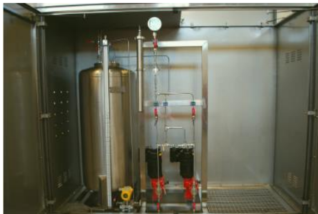
Figura 87. Sistema de Odorización (Fluideco, 2022).
