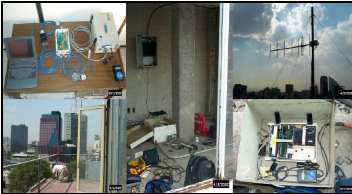
Figura 5.1. Pruebas de Comunicación e Instalación
