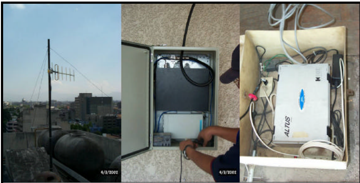
Figura 5.12. Instalación de Antena y Panel de Instrumentos
