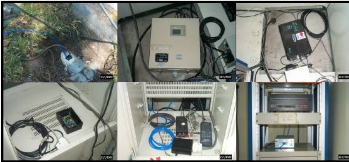
Figura 6.5. Implementación e Instalación del SIR-Roma
