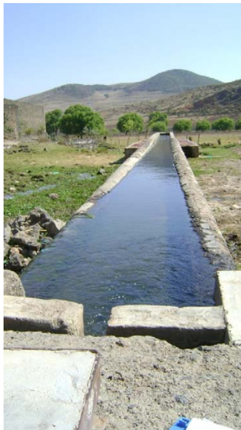
Fig. 3.10 Contenedor para el abastecimiento de agua potable en Michac.
