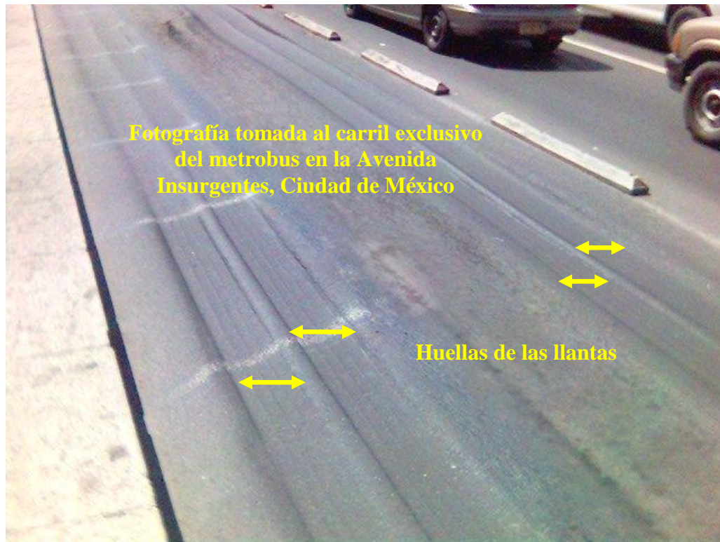
Figura 2.23 Deformaciones provocadas por el transitar diario del metrobus
