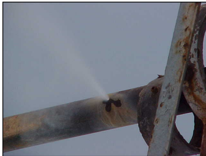
Figura 5.2. Fuga en un absorbedor.
