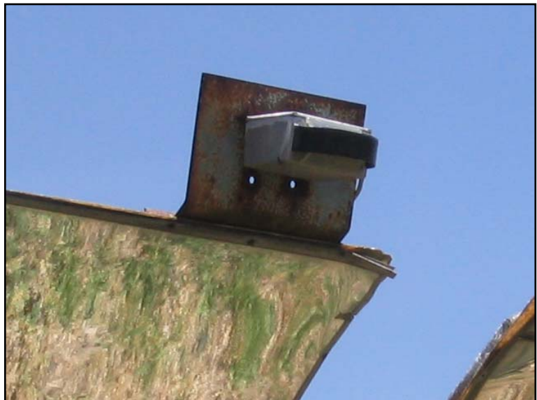
Figura 4.27. Caja que resguarda a los fototransistores.
