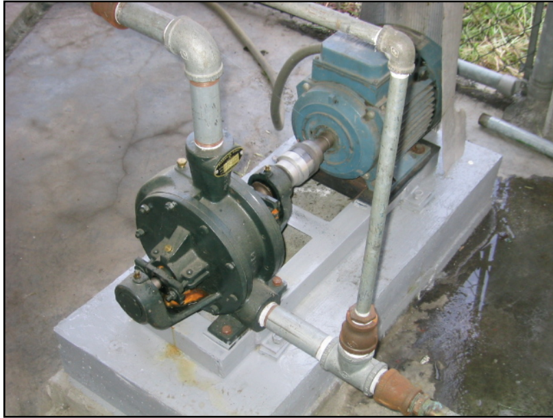
Figura 3.50. Conjunto motor-bomba de suministro.
