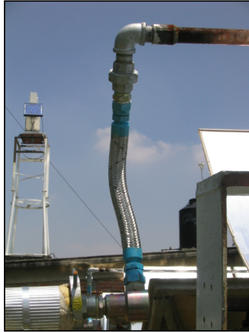
Figura 5.1. Manguera de conexión.
