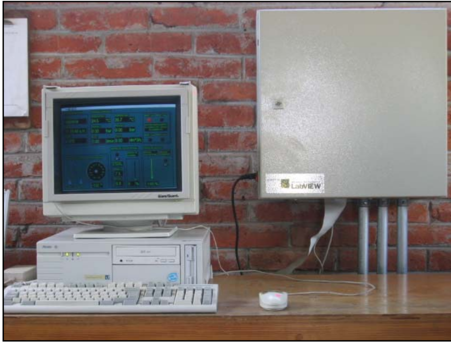
Figura 4.40. Ubicación final de la computadora personal y gabinete.
