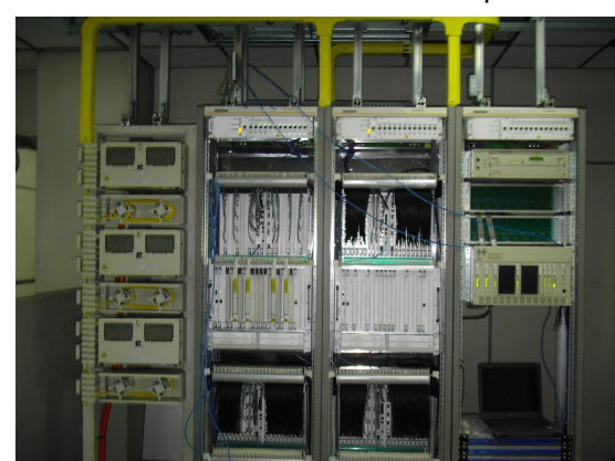
Equipos de Transmisión
