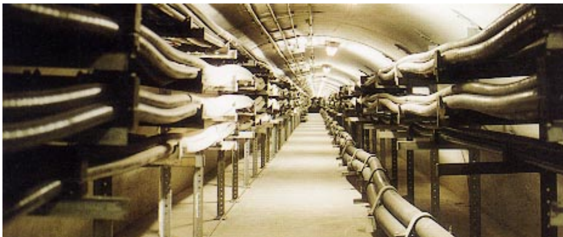
Fig. 2 g) Alimentadores Subterráneos
