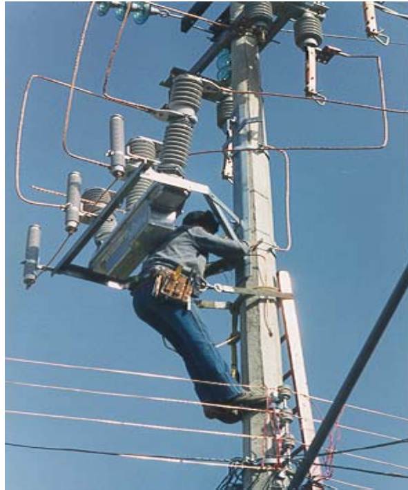
1 l).-Instalación de medios de seccionamiento para reducción del TIU
