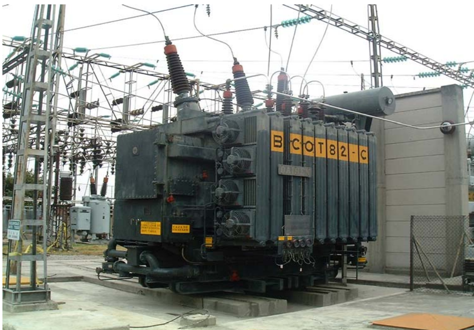
Fig. 2 d) Subestación de potencia reductora 85 kV/23 kV.
