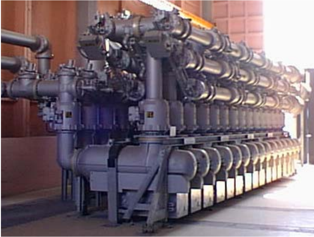
1 j).- Primera Subestación en SF6 ( San Ángel, 1977 )
