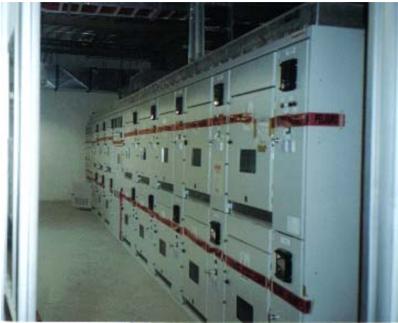
Fotografía 9.- Cuarto de control de la subestación.
