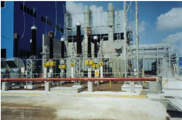
Fotografía 6.- Transformador Principal de la Unidad de Vapor.
