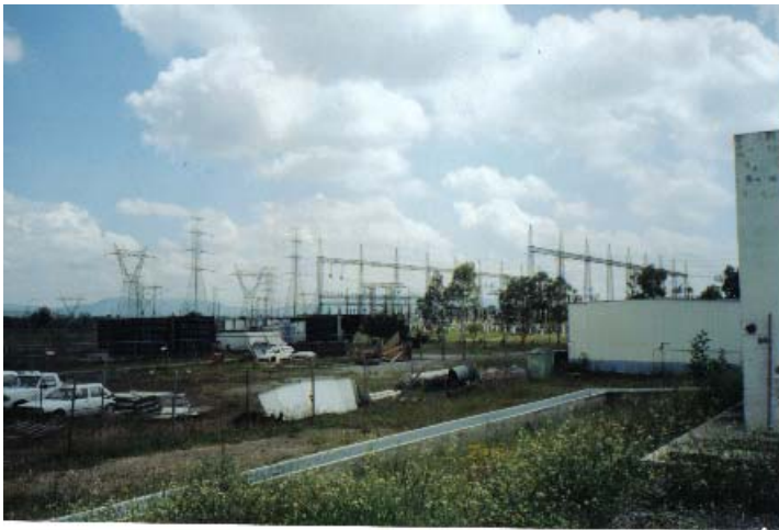
Fotografía 8.- Subestación de El Sauz.
