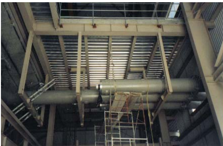
Fotografía 5.- Bus de fase aislada de la unidad de vapor.
