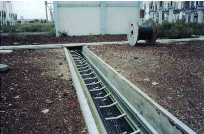
Fotografía 10.- Cables de comunicación del cuarto de control de subestación.
