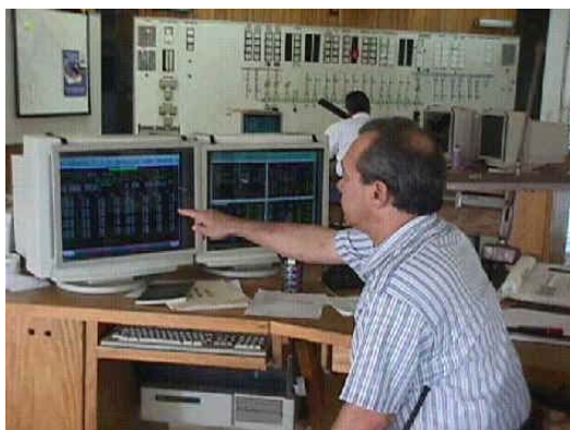
Figura 4.4.- Estación de trabajo de RANGER.
