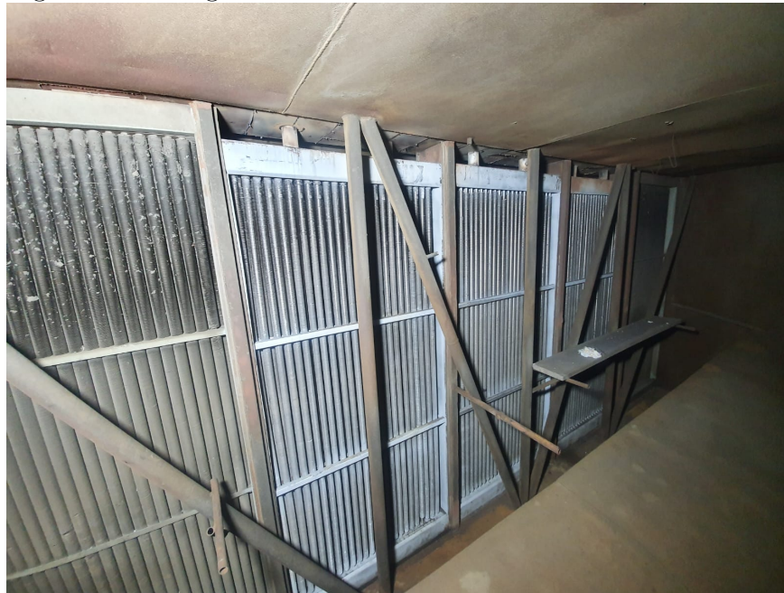
Figura 6.2: Fotografía de interior de intercambiador de calor - 2
