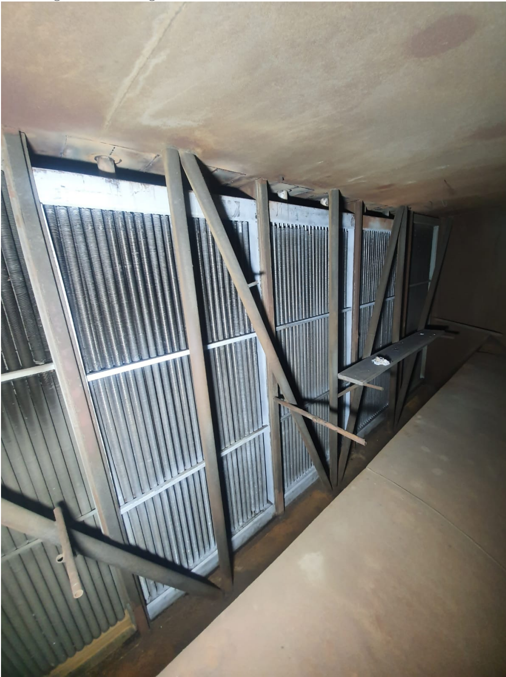
Figura 6.4: Fotografía de interior de intercambiador de calor - 4
