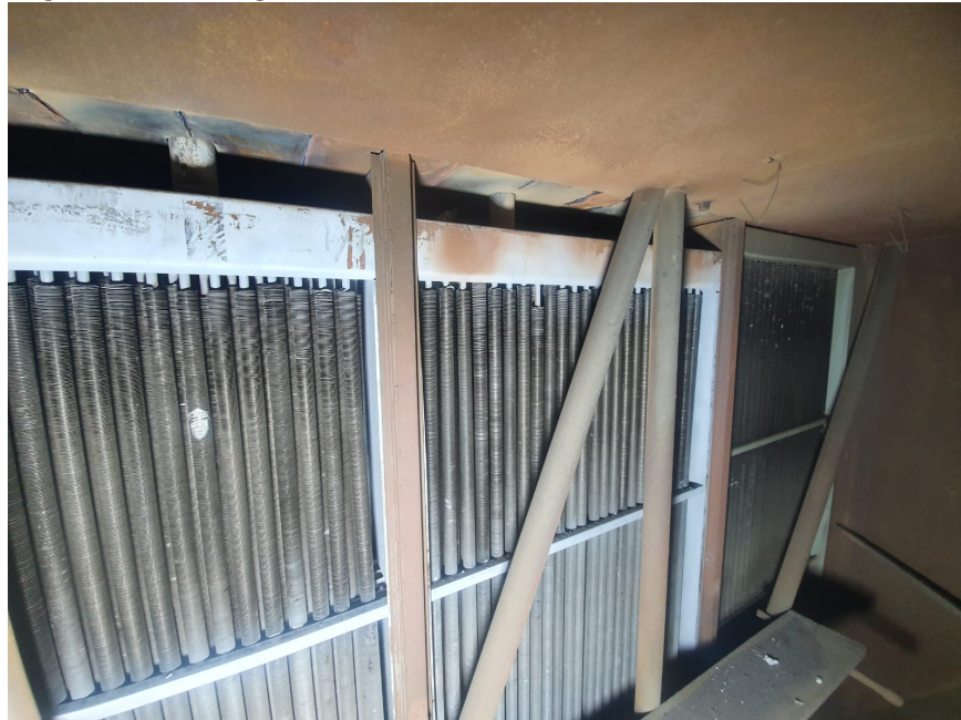
Figura 6.3: Fotografía de interior de intercambiador de calor - 3
