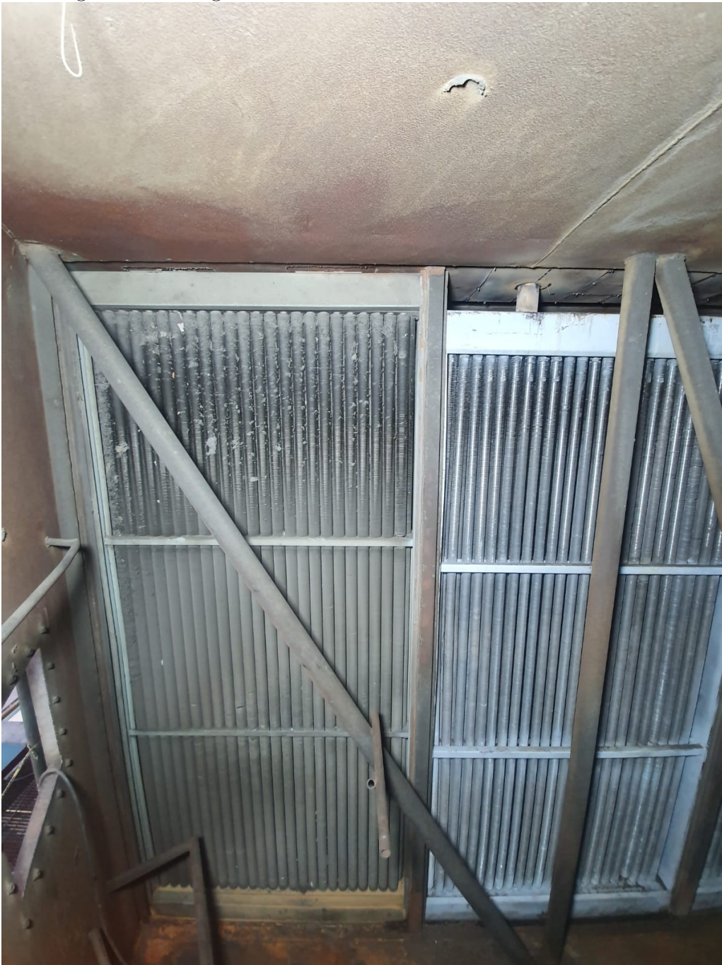
Figura 6.5: Fotografía de interior de intercambiador de calor - 5
