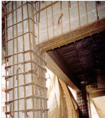
Figura 4.1 Viga encamisada con refuerzo longitudinal no continuo a través del nudo con la columna. Fuente: coreandcut.com
