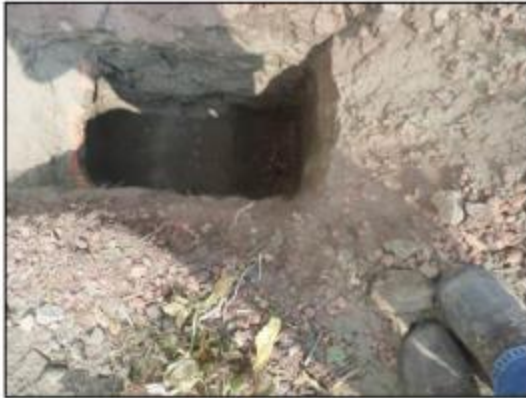
Interior del PCA-3
