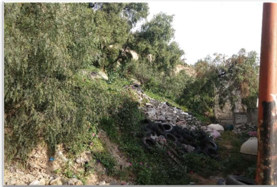
Foto 4 Parte trasera de casa afectadas por caída de material en talud Texalpa.
