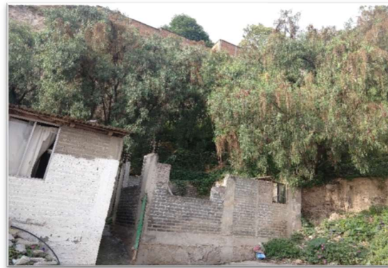
Foto 3 Domicilios afectados en la base del talud.
