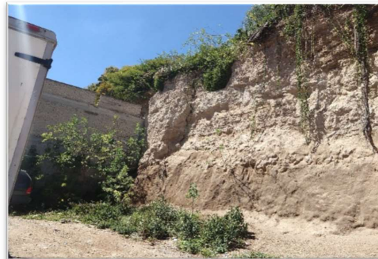
Foto 9 Construcciones en contacto directo con la cara del talud.
