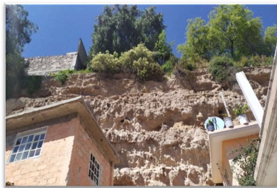
Foto 7 Cárcavas y huecos en la cara del talud y casa descansando sobre esta.
