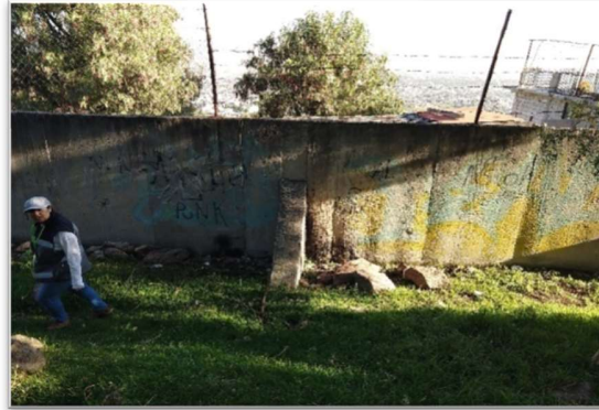
Foto 25 Vista de perfil en dirección sur de la zona de desprendimientos.
