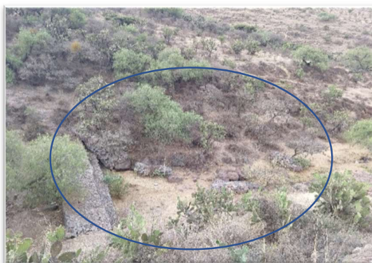
Foto 12 Gaviones Dañados por los Flujos ocurridos en la zona.
