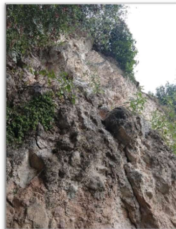
Foto 17 Pared del talud con rocas salientes y en peligro de caída.
