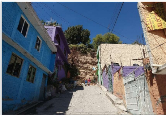
Foto 8 Casas con posible afectación por desprendimiento de material del talud.
