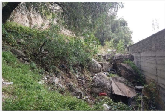
Foto 16 Caídos de rocas en las bardas de las casas.
