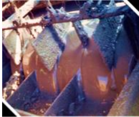
Figura 16 Temblorina, primer equipo mecánico separador de sólidos, encargado de los recortes de mayor tamaño.
