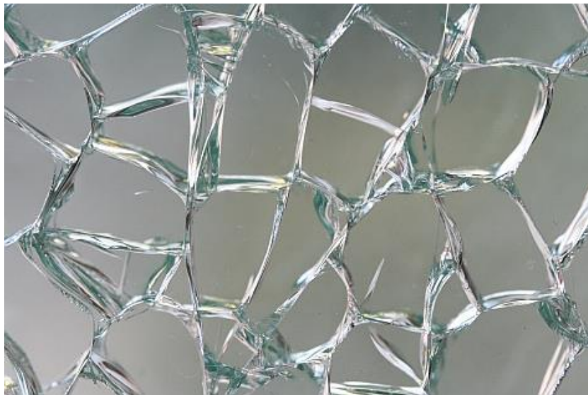
Fig. 23 Rotura de vidrio templado
