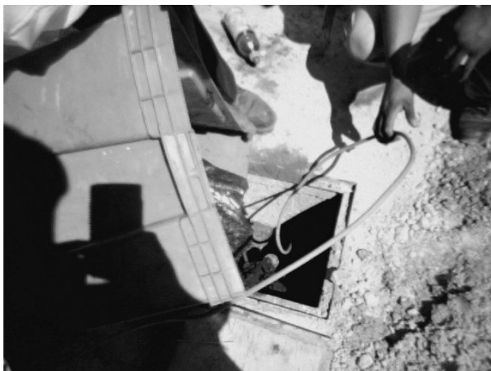
Figura 45.- Conexión Pararrayos a Electrodo de Tierra.
