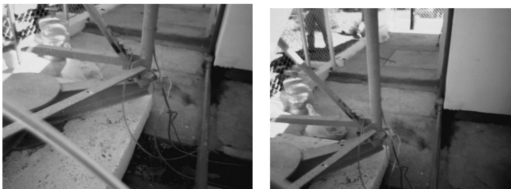
Figura 46.- Conexión a Tierra del Cable bajante del pararrayos.
