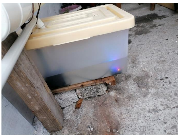
10.3.4.7: Bomba sumergible dentro del contenedor
