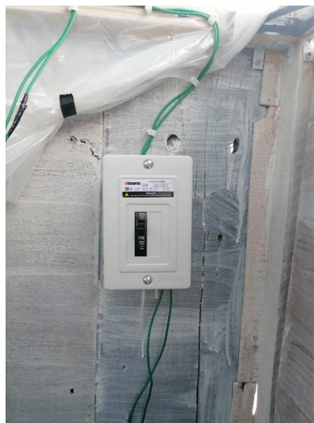
10.4.10: Centro de carga
