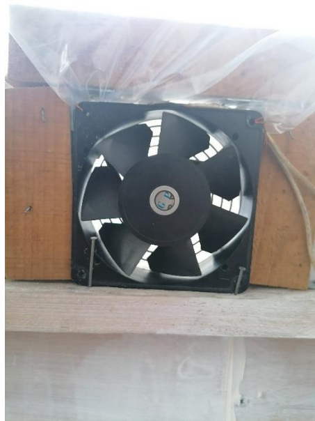
10.3.1.28: Ventilador para ingreso de aire
