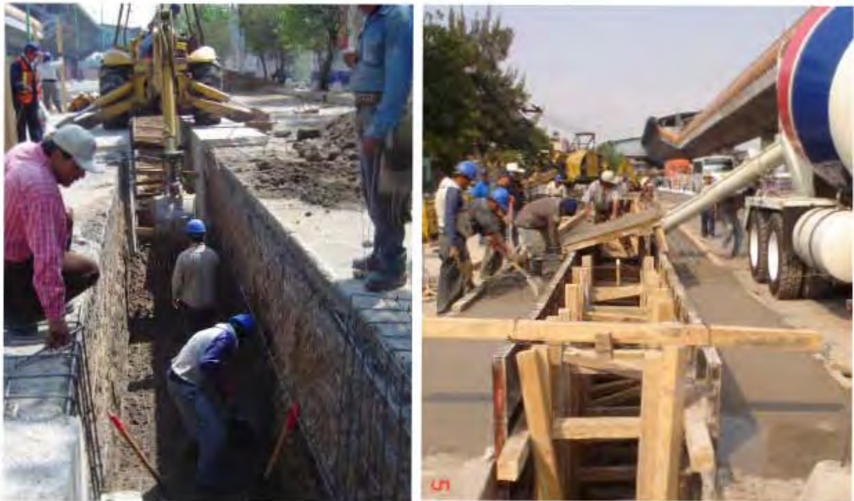
Figura 24. Izq. Excavación de zanja para brocal y armado del acero. Der. Cimbra y colado de brocal.
