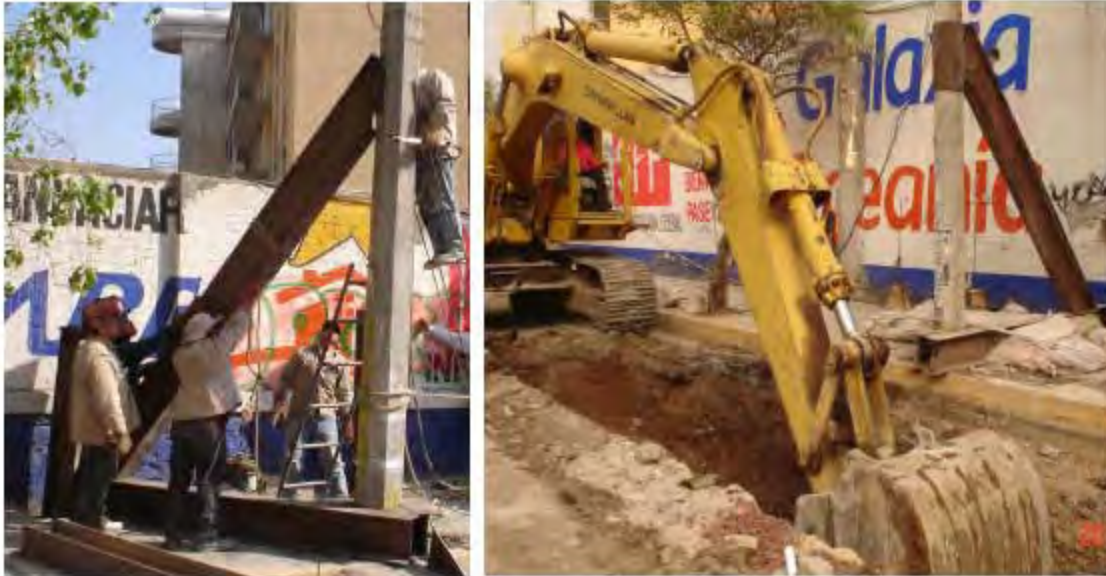
Figura 8. Izq. Estabilización de los postes de alta tensión. Der. Excavación para tubería de drenaje
