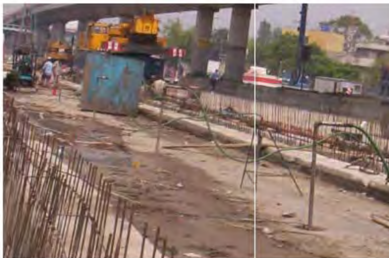
Figura 35. Pozos de bombeo.
