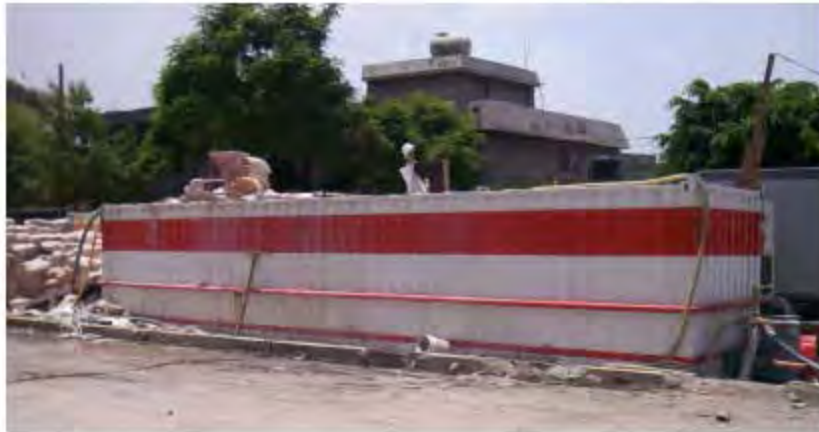
Figura 32. Tanque de lodos bentoníticos.
