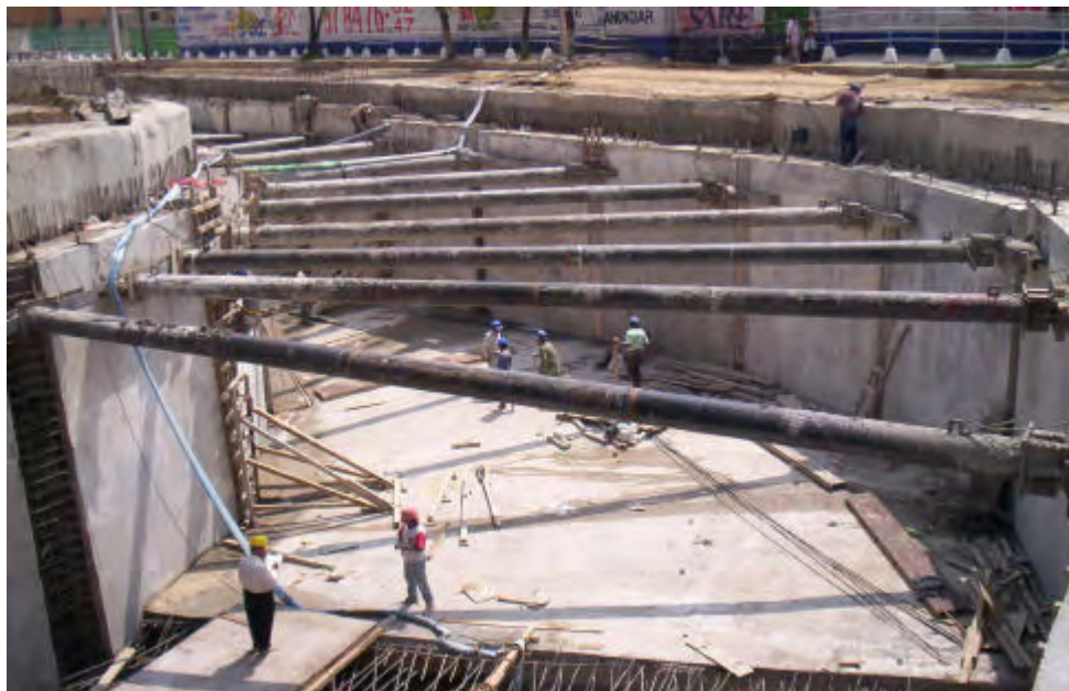
Figura 41. Troquelamiento en zona de curva.
