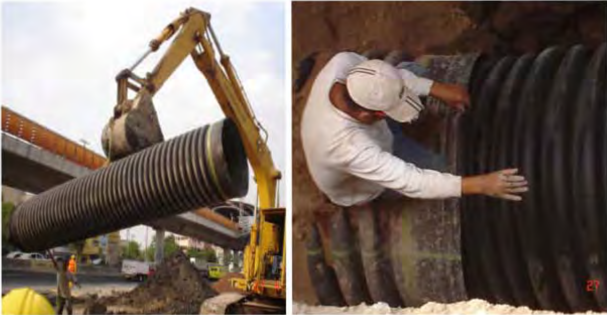
Figura 10. IZQ izaje de la tubería con ayuda de la retroexcavadora, DER unión entre la espiga y campana
