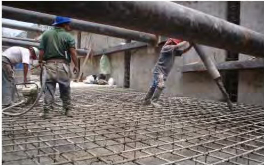
Figura 54. Colado de losa de fondo, con concreto bombeable y compactación con vibrador de inmersión.
