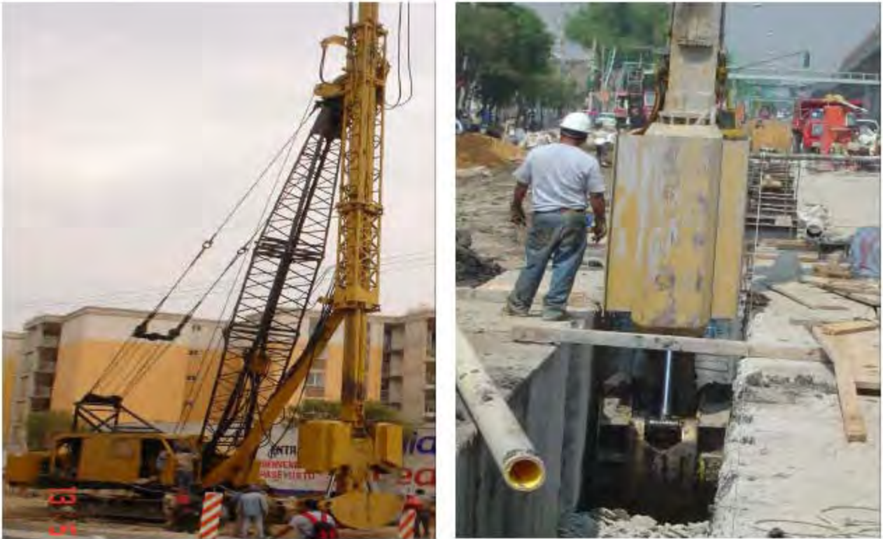
Figura 27. Izq. Draga con equipo guiado. Der Excavación de trinchera con almeja guiada
